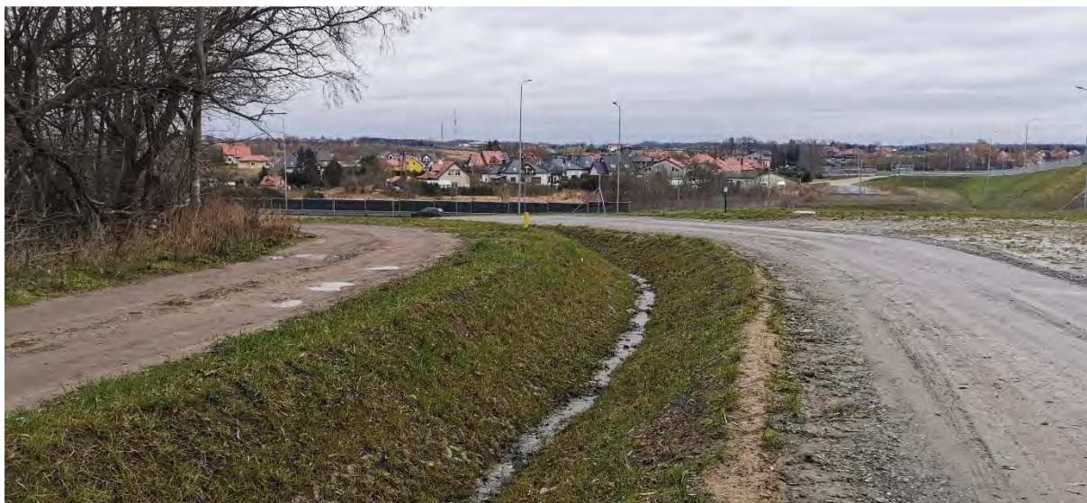
Rysunek 13 Na zdjęciu: roślinność wokół budowli odwadniającej skrzyżowanie przy drodze ekspresowej – przystrzyżone trawy na skarpach, drożne rowy odwadniające, Źródło: autor: I. Szymańska, listopad 2020 r.
