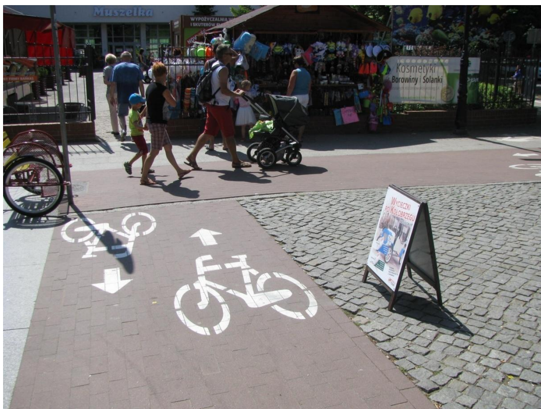
Fotografia 2.2 Miejsowy przebieg drogi rowerowej na ul. Rodziewiczówny bez odpowiednich łuków źródło: zdjęcie własne
