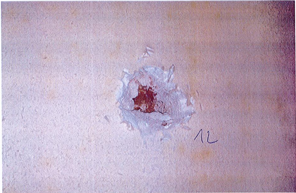
Fot.41. Kołobrzeg, Ratusz, Restauracja Adabar, sala myśliwska, ściana południowa, odkrywki sondażowe. Ściany Sali myśliwskiej pokryto konsekwentnie tynkiem cementowym.
