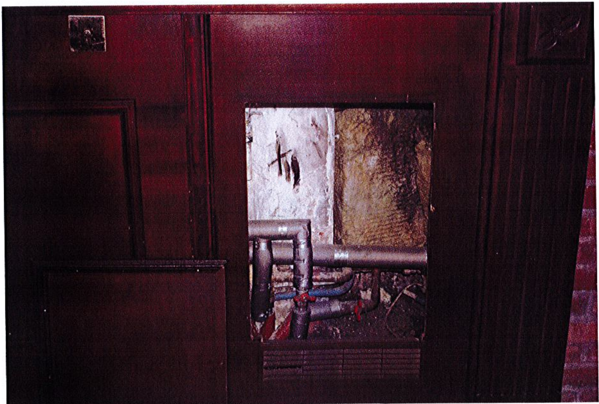
Fot.56. Kołobrzeg, Ratusz, Restauracja Adabar korytarz zaplecza. Silne i nietypowe zawilgocenie ściany działowej.
