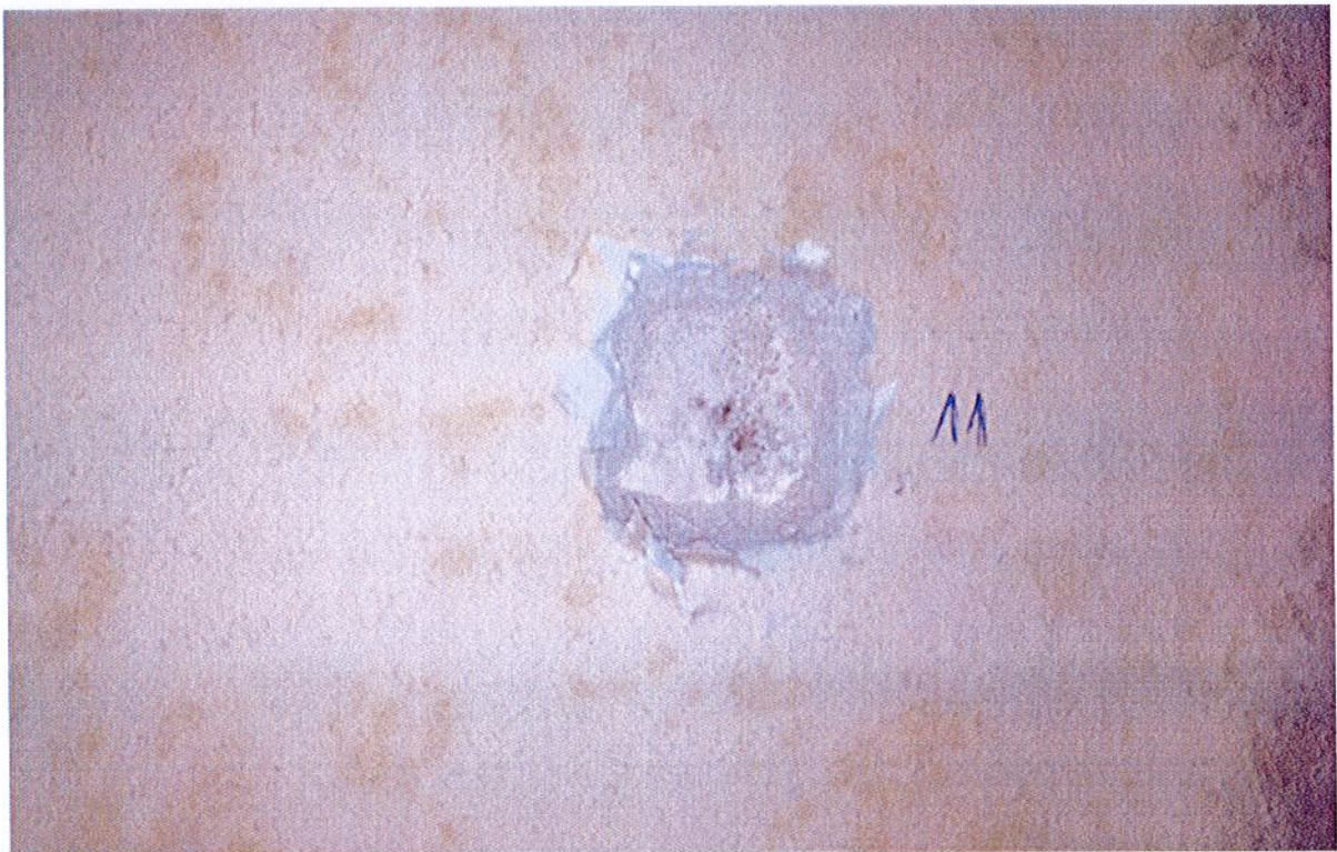
Fot.40. Kołobrzeg, Ratusz, Restauracja Adabar, sala myśliwska, ściana południowa, odkrywki sondażowe. Ściany Sali myśliwskiej pokryto konsekwentnie tynkiem cementowym.
