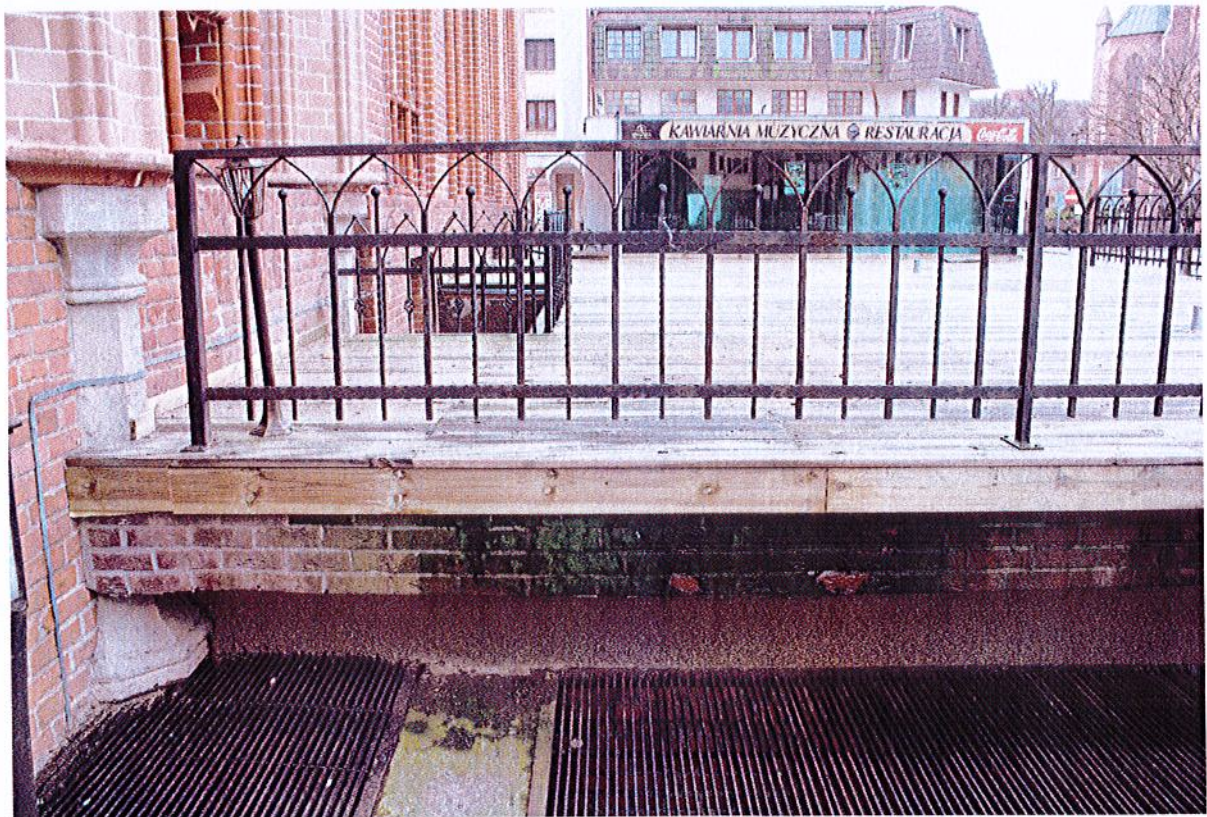
Fot.6. Kołobrzeg, Ratusz, Restauracja Adabar. Płyta tarasu wykazuje silne tendencje do utrzymywania zawilgocenia. Tak silny rozwój glonów możliwy jest jedynie w warunkach stałego zawilgocenia.
