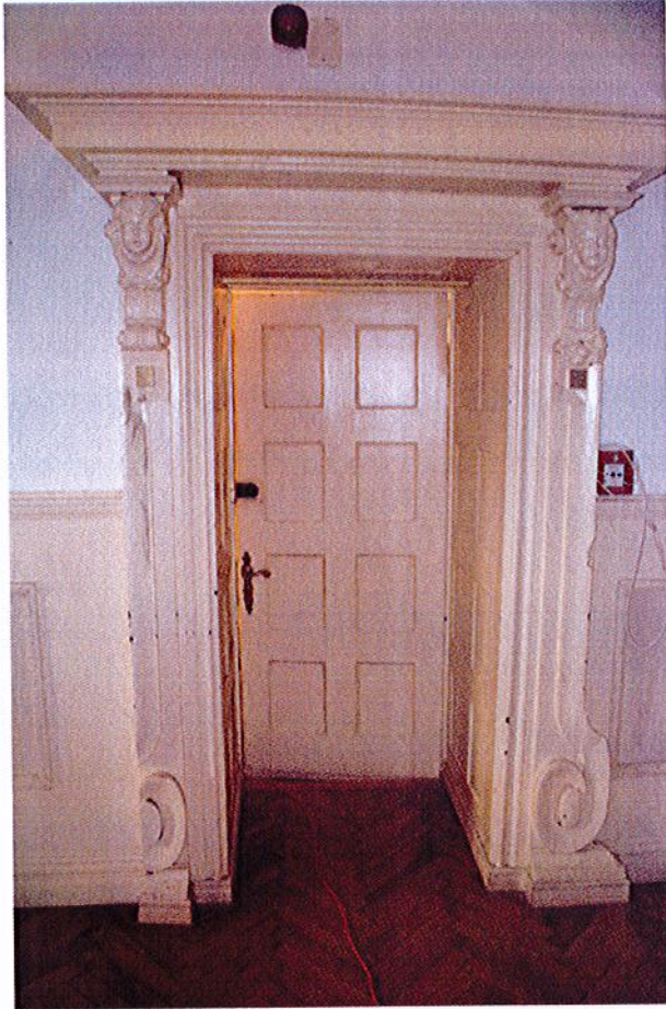
Fot.49. Kołobrzeg, Ratusz, Restauracja Adabar, sala różana. Ościeżyna z zachowanym skrzydłem ramowo-płycinowy, awers. W strefie cokołowej widoczne duże uszkodzenie woluty opaski. Szyld i klamka są współczesne, analogiczne do drzwi w korytarzu i toalet dla gości.
