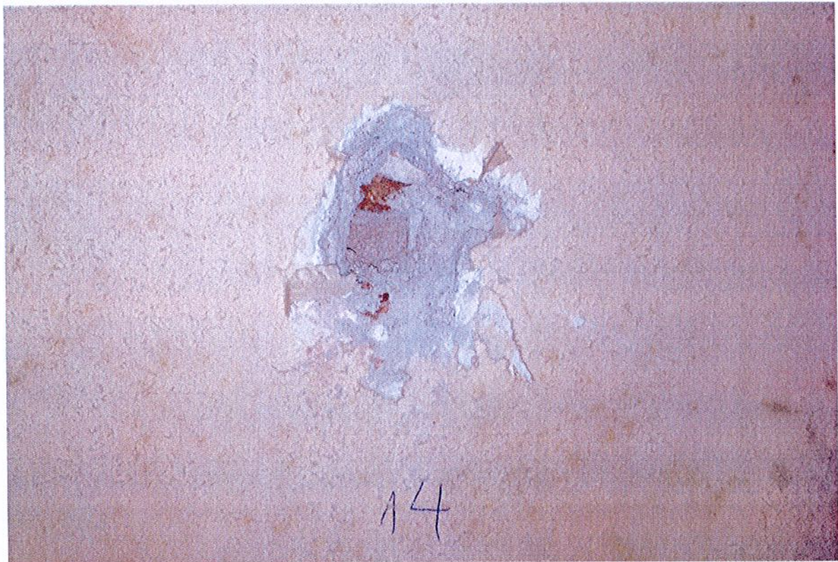
Fot.42. Kołobrzeg, Ratusz, Restauracja Adabar, sala myśliwska, ściana zachodnia, odkrywki sondażowe. Ściany Sali myśliwskiej pokryto konsekwentnie tynkiem cementowym.
