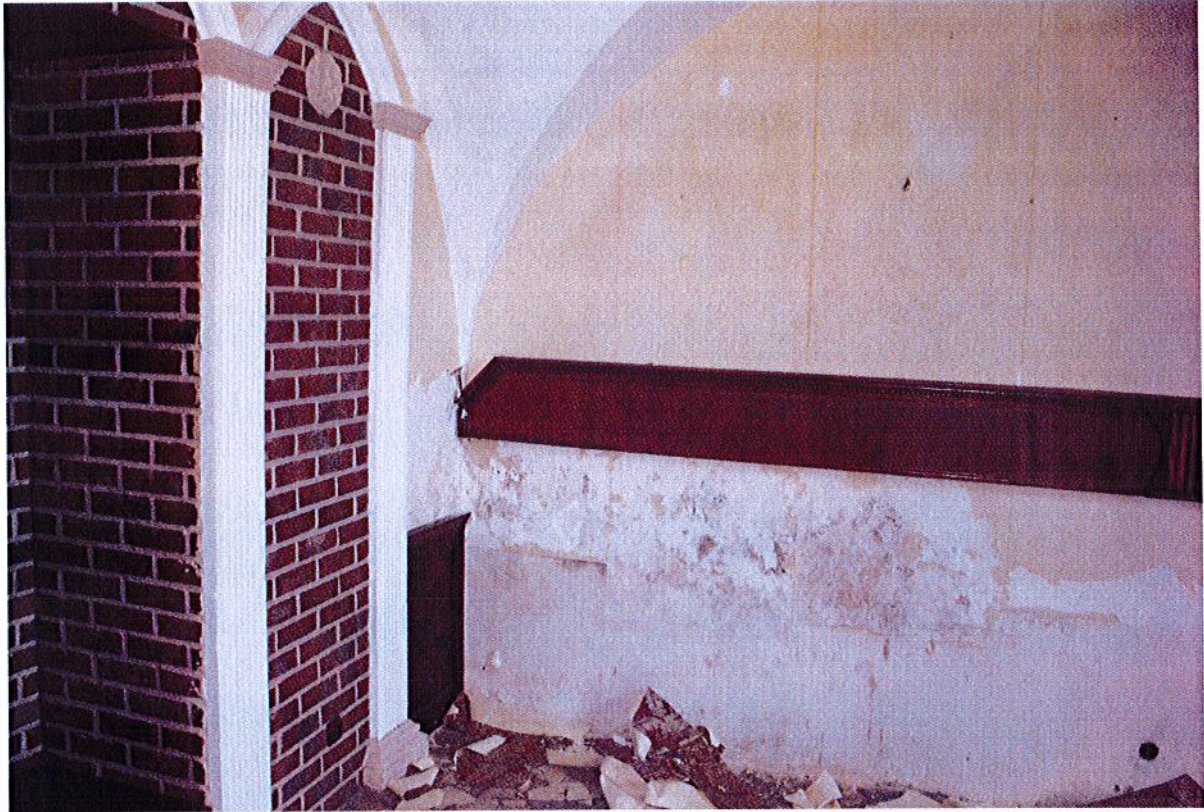
Fot.43. Kołobrzeg, Ratusz, Restauracja Adabar, sala myśliwska. Podobnie jak w pozostałych pomieszczeniach ściany stały się siedliskiem rozległych kolonii grzybów strzępkowych.
