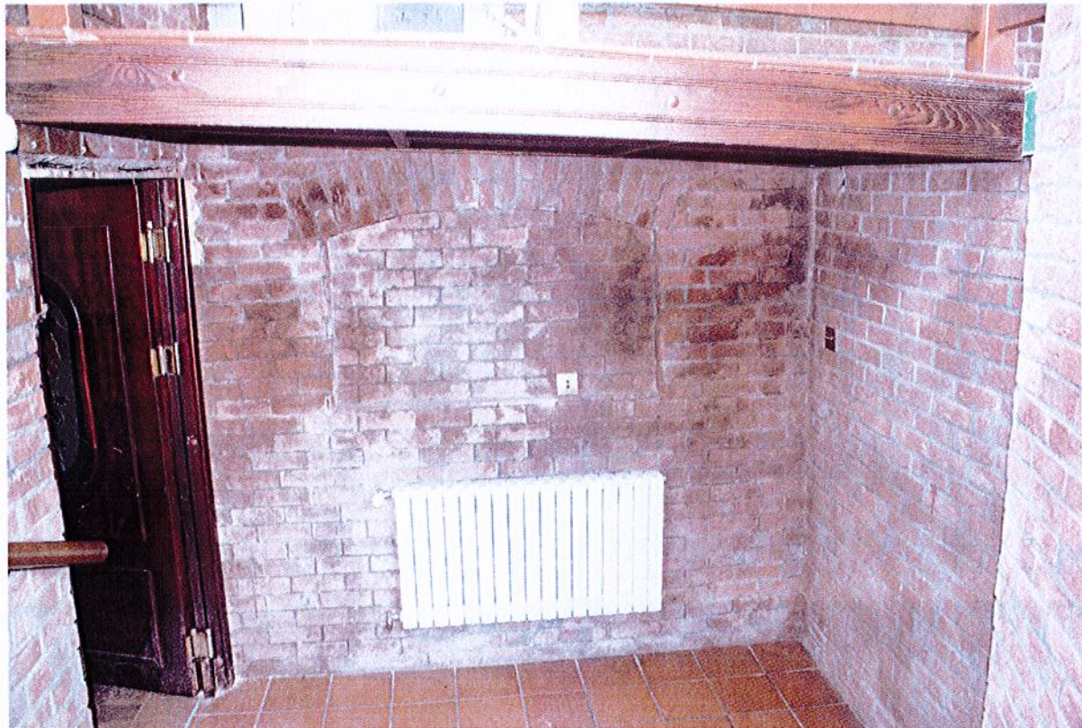
Fot.10. Kołobrzeg, Ratusz, Restauracja Adabar, wnętrze klatki schodowej. Czytelność procesów korozyjnych potęguje rodzaj zastosowanych w nowej części materiałów. Najtańsze materiały murarskie ogólnego zastosowania zawierają duże ilości soli rozpuszczalnych w wodzie, które w niekorzystnych warunkach powodują powstawanie zacieków i wysoleń.
