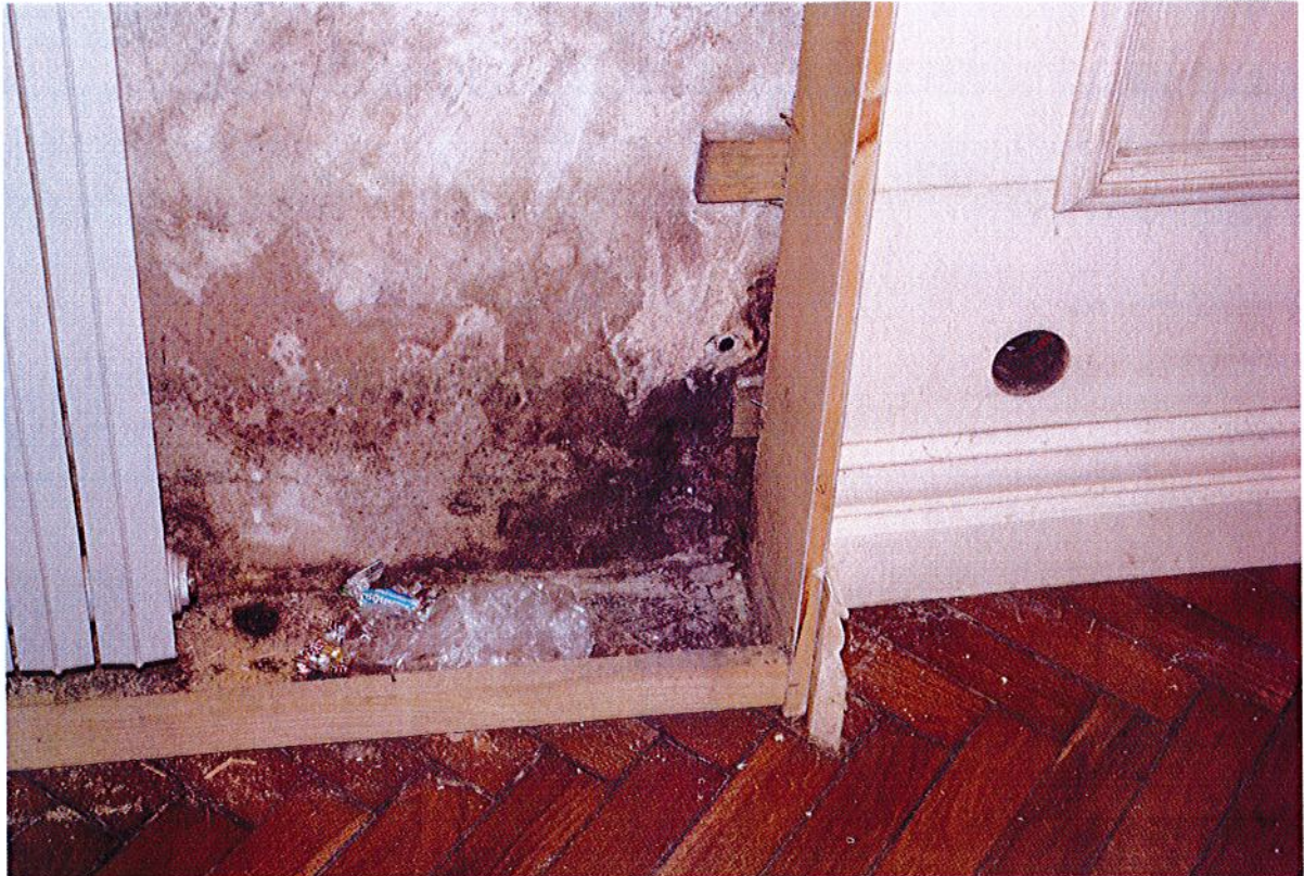
Fot.51. Kołobrzeg, Ratusz, Restauracja Adabar, sala różana. Ślady zawilgocenia w strefie przyziemia pomieszczenia. Pomimo dramatycznego wyglądu próbki nie wykazały obecności grzybów strzępkowych ani domowych. Pomiar wilgotności metodą elektrooporową wykazał w tym miejscu 54% wilgotności względnej (materiał suchy do około 20%).
