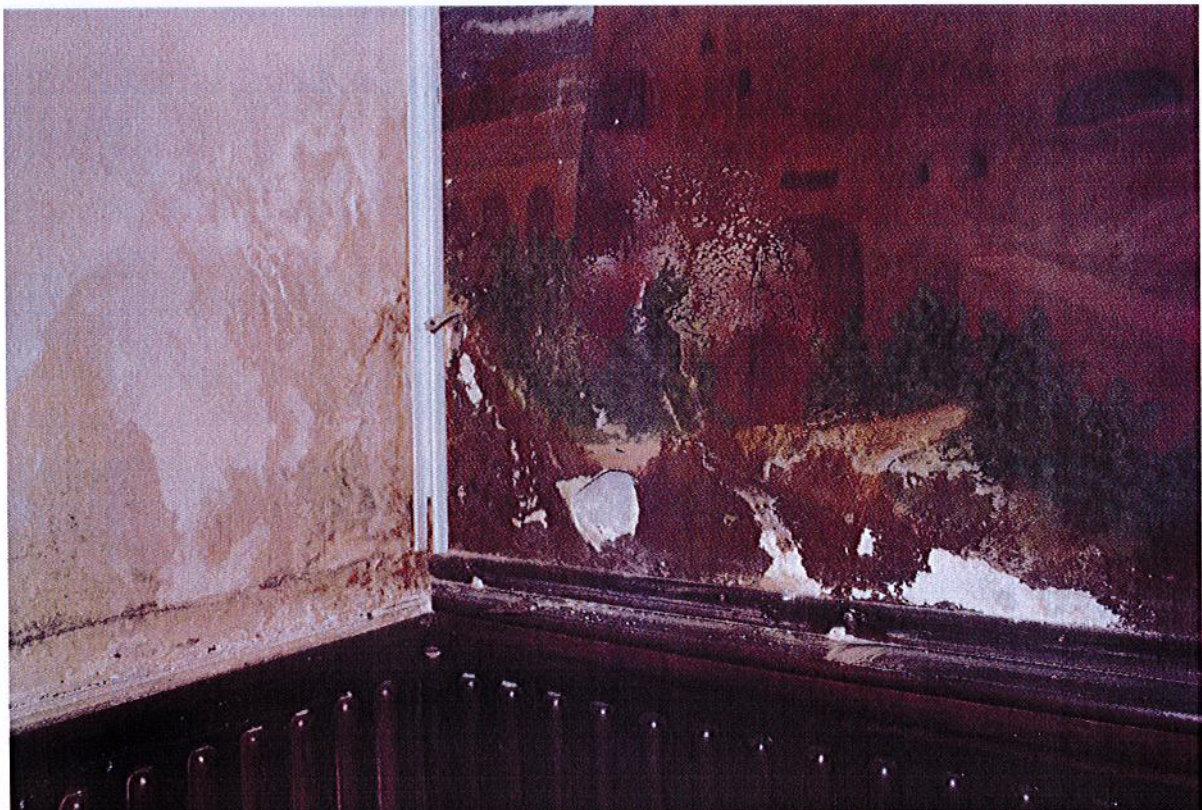
Fot.20. Kołobrzeg, Ratusz, Restauracja Adabar, główna sala restauracji. Objawy zawilgocenia widoczne są także w pozostałych pomieszczeniach restauracji, zwłaszcza na ścianach sąsiadujących z fosą. Na zdjęciu, po lewej widoczna ściana murów obwodowych a po prawej prostopadła do niej ściana działowa. Obie zawilgocone w stopniu umożliwiającym działanie soli rozpuszczalnych w wodzie.
