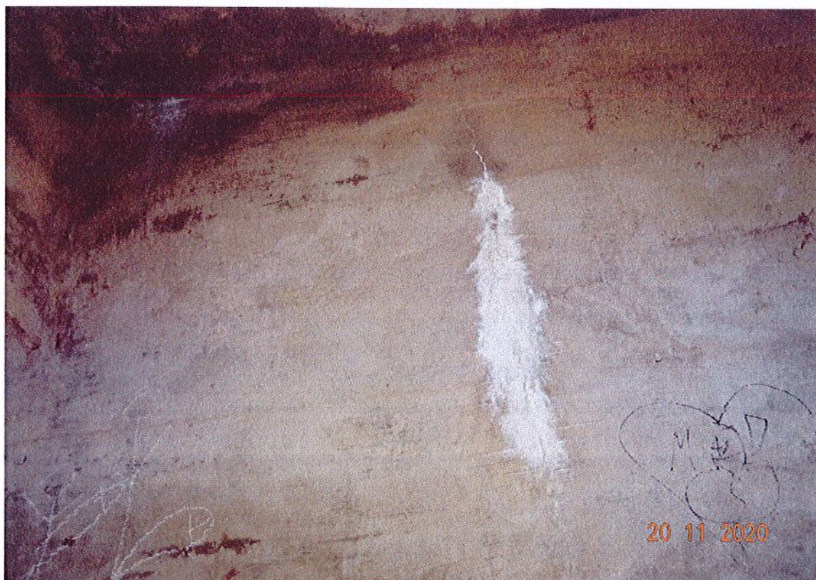
Fot. 23. Widok pierwszego dźwigara od strony Kanału Drzewnego. Widoczne pęknięcie powierzchni z wykwitami i naciekami.
