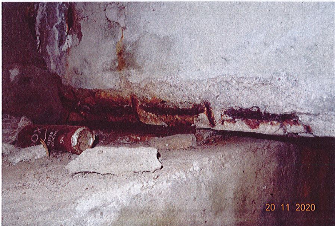
Fot. 22. Widok dźwigara wspartego na podporze. Łożysko mocno skorodowane, Widoczne ubytki i odpęnięcia powierzchni dźwigara, wyraźnie skorodowane zbrojenie.
