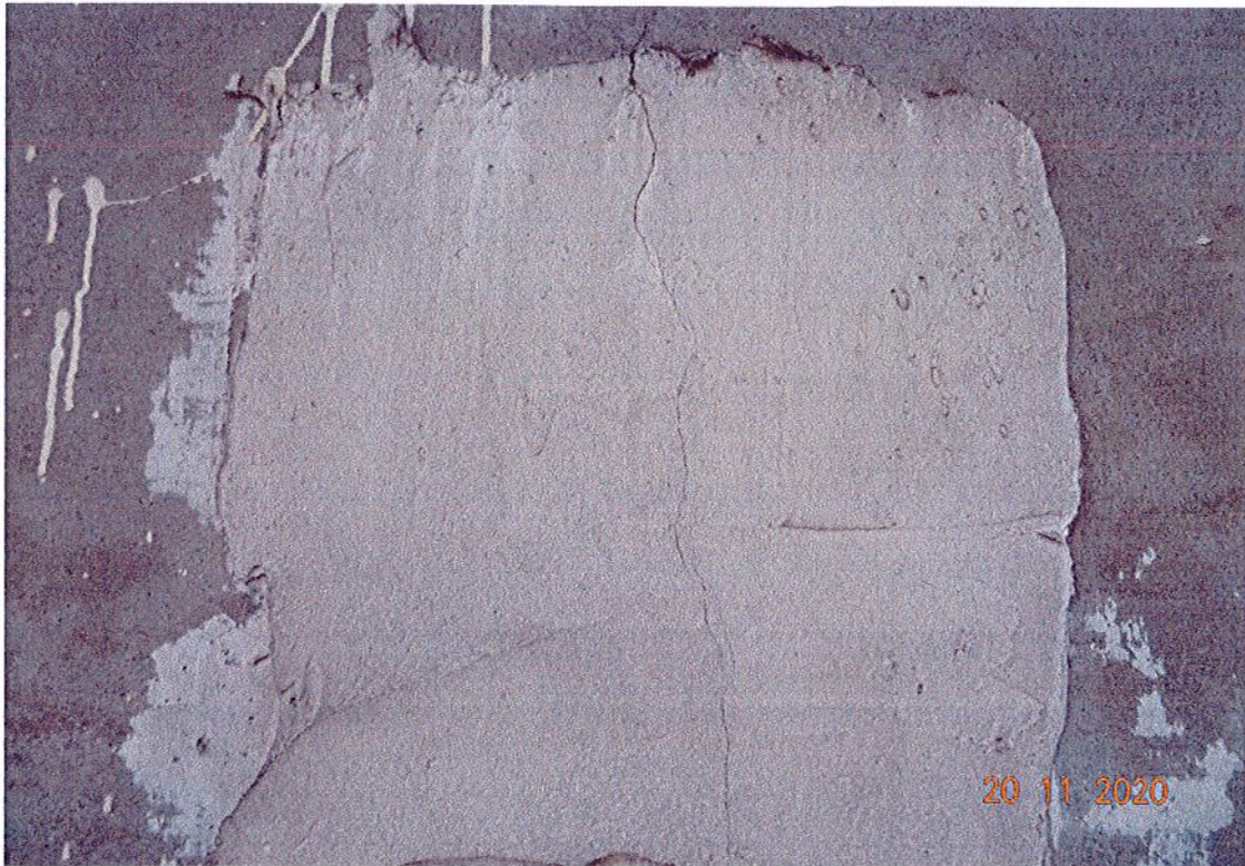
Fot. 15. Widok pierwszego dźwigara od strony Parsęty. Widoczny znacznik na powierzchni konstrukcji z wyraźnym pęknięciem prostopadłym do osi obiektu.
