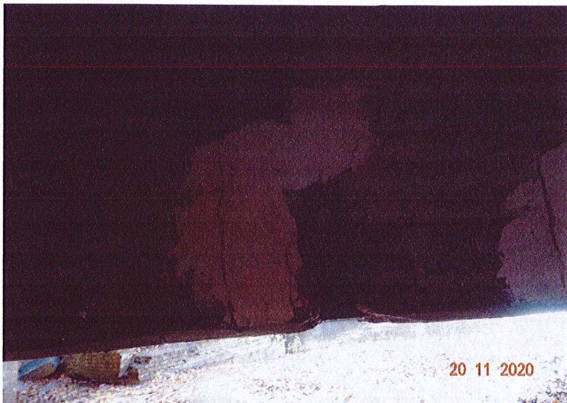
Fot. 19. Widok drugiego dźwigara od strony Kanału Drzewnego. Widoczny znacznik na powierzchni z wyraźnym pęknięciem pionowym oraz odkryte zbrojenie na spodzie dźwigara.
