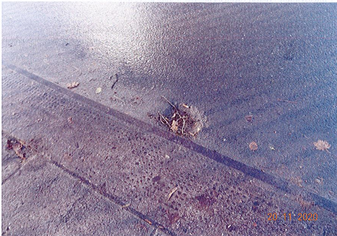
Fot. 27. Widok niedrożnego wpustu ulicznego na obiekcie od strony Kanalu Drzewnego.
