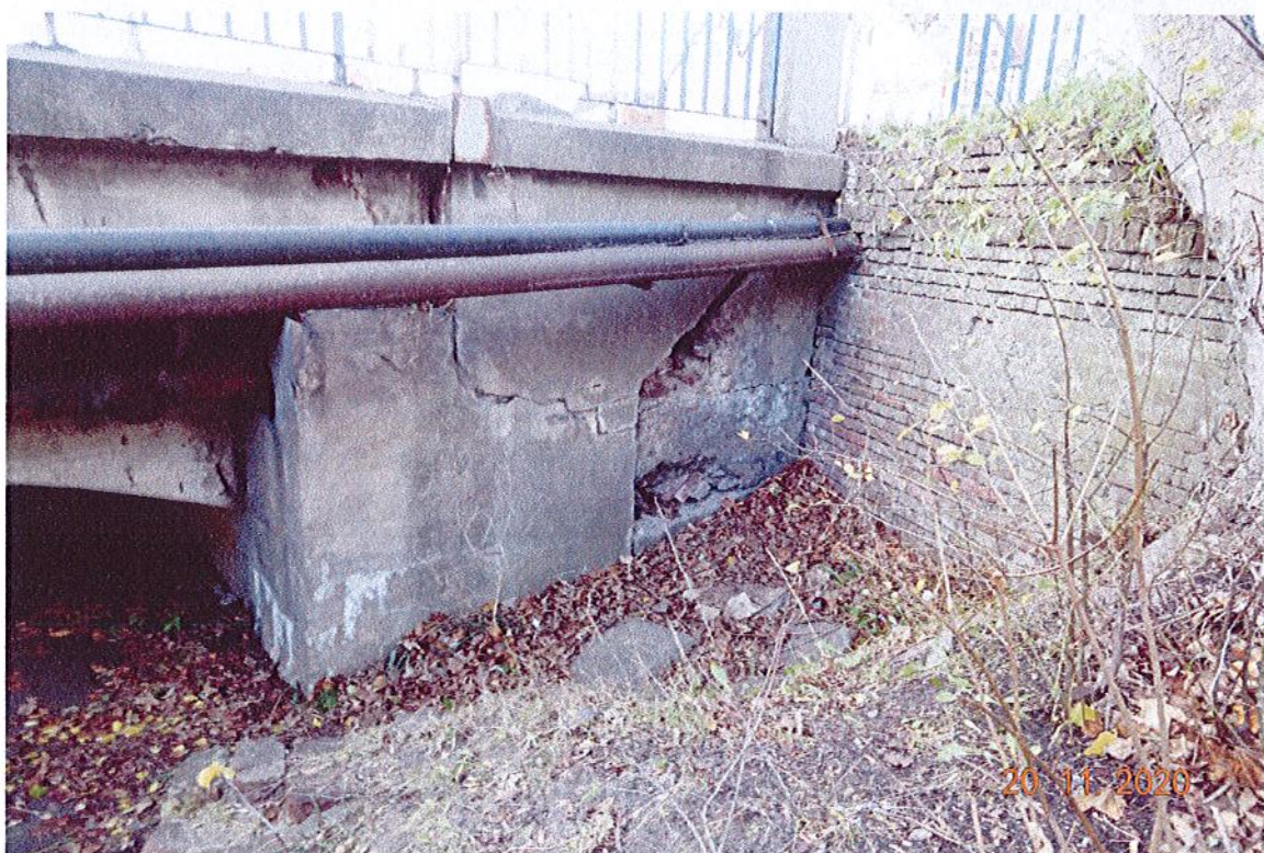
Fot. 12. Widok prawego przyczółka od Kanału Drzewnego. Widoczne spękania i ubytki w konstrukcji przyczółka. Nacieki i przebarwienia w okolicy spękań.
