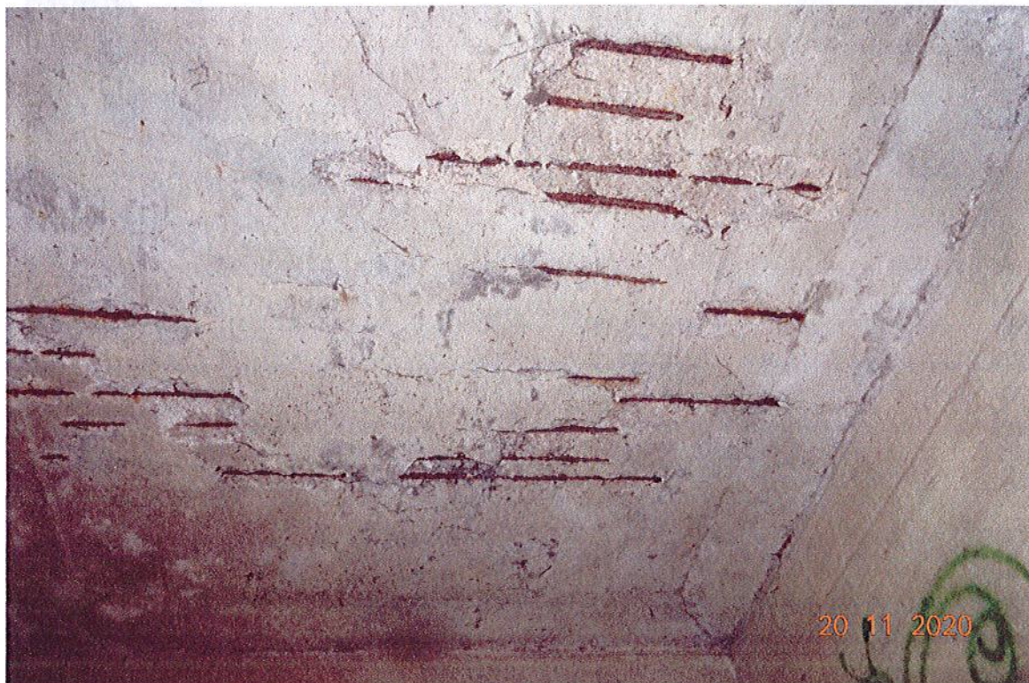
Fot. 18. Widok płyty pomostu. Widoczne pręty zbrojenia płyty wyraźnie skorodowane oraz ubytki i spękania w betonowej powierzchni płyty.
