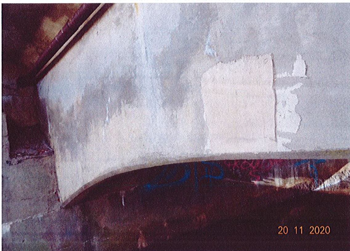
Fot. 14. Widok pierwszego dźwigara od strony Parsęty przy lewej podporze. Widoczny znacznik na powierzchni konstrukcji z wyraźnym pęknięciem prostopadłym do osi obiektu.
