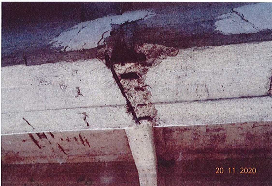
Fot. 20. Widok środkowego dźwigara. Widoczne odkryte zbrojenie na spodzie dźwigara po odkuciu po sprawdzaniu stanu zbrojenia.
