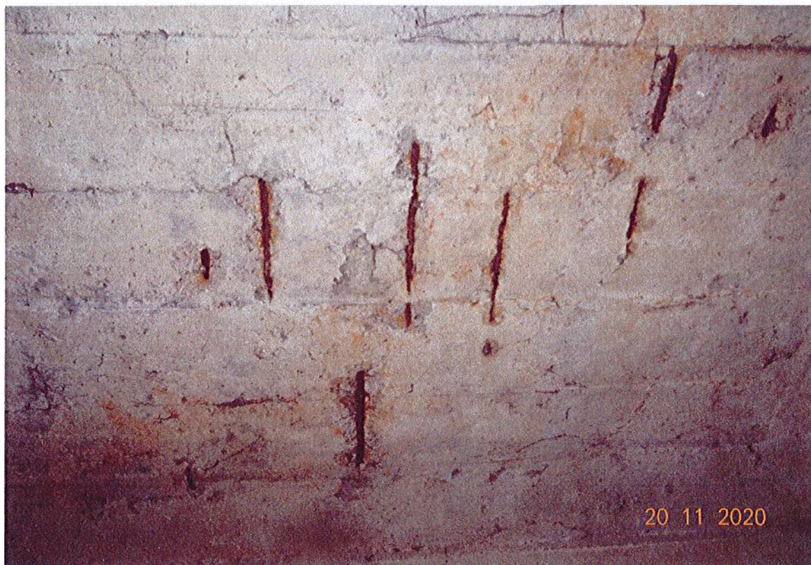
Fot. 17. Widok płyty pomostu. Widoczne pręty zbrojenia płyty wyraźnie skorodowane oraz ubytki i spękania w betonowej powierzchni płyty.
