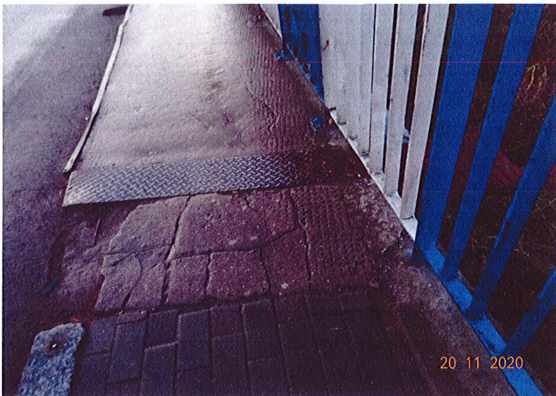
Fot. 25. Widok nawierzchni chodnika od strony Parsęty. Widoczne nierówności i ubytki nawierzchni przy płycie dylatacyjnej. Widoczne ślady ognisk korozji na balustradzie.
