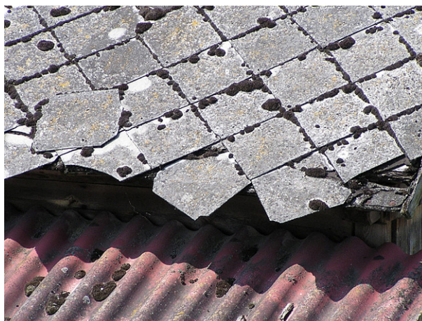
Rys. 12. Pokrycie dachowe ocenione w I stopniu pilności.
