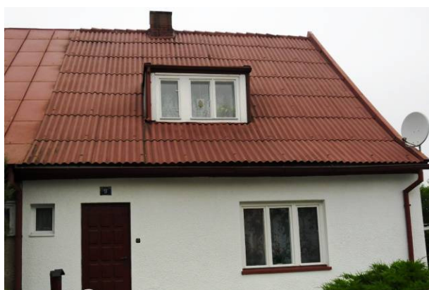
Rys. 10. Pokrycie dachowe ocenione w III stopniu pilności.
