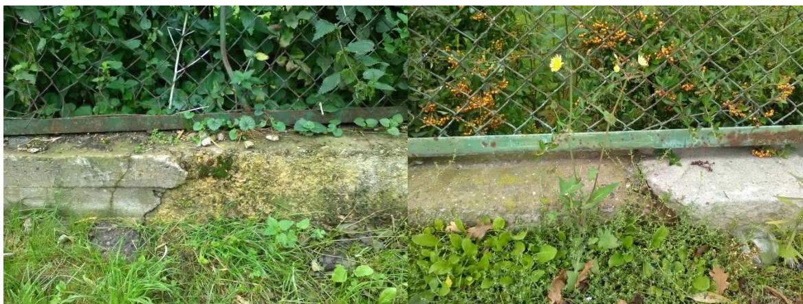
Uszkodzenia istniejącego cokołu
