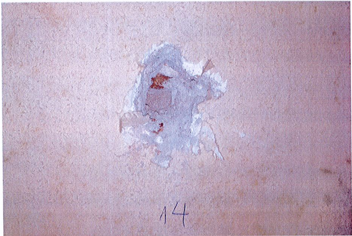
Fot.42. Kołobrzeg, Ratusz, Restauracja Adabar, sala myśliwska, ściana zachodnia, odkrywki sondażowe. Ściany Sali myśliwskiej pokryto konsekwentnie tynkiem cementowym.
