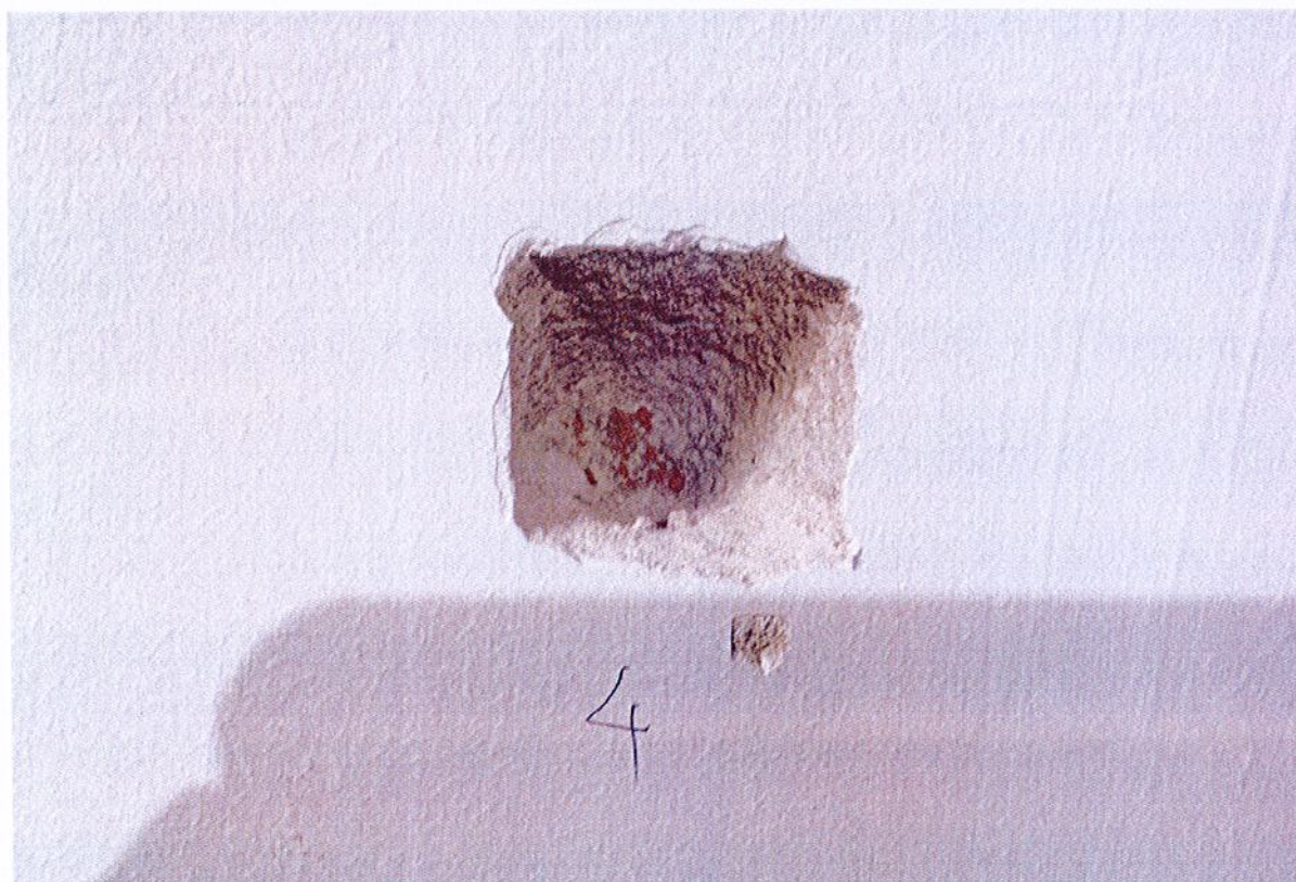
Fot.34. Kołobrzeg, Ratusz, Restauracja Adabar, główna sala restauracji. Sklepienie nad kolumną z pierwszej fazy chronologicznej. Obecne na ścianach zaprawy to w badanych miejscach to w większości materiały współczesne, jednowarstwowe i homogeniczne w budowie.
