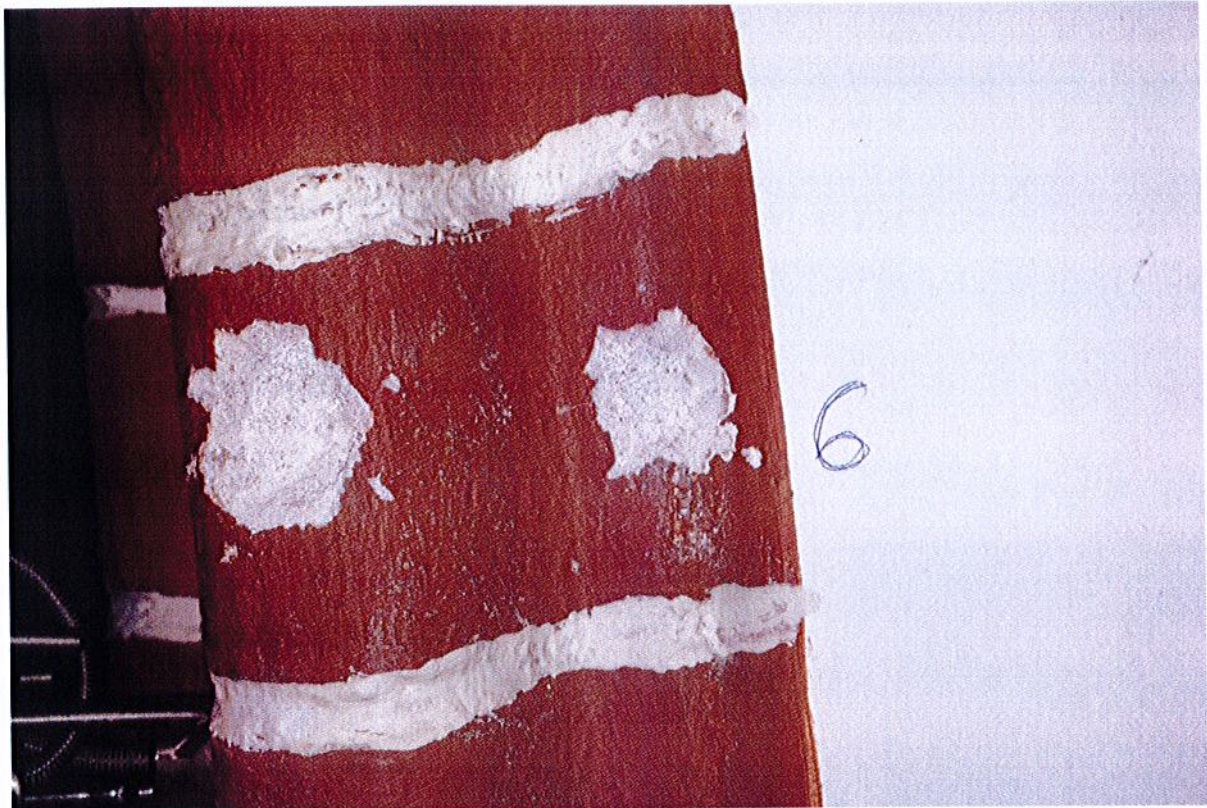
Fot.31. Kołobrzeg, Ratusz, Restauracja Adabar, główna sala restauracji. Odkrywki sondażowe żeber nad kolumną z II fazy chronologicznej. Obecne na sklepieniach żebrowanie jest w większości wykonaną w narzucie rekonstrukcją.
