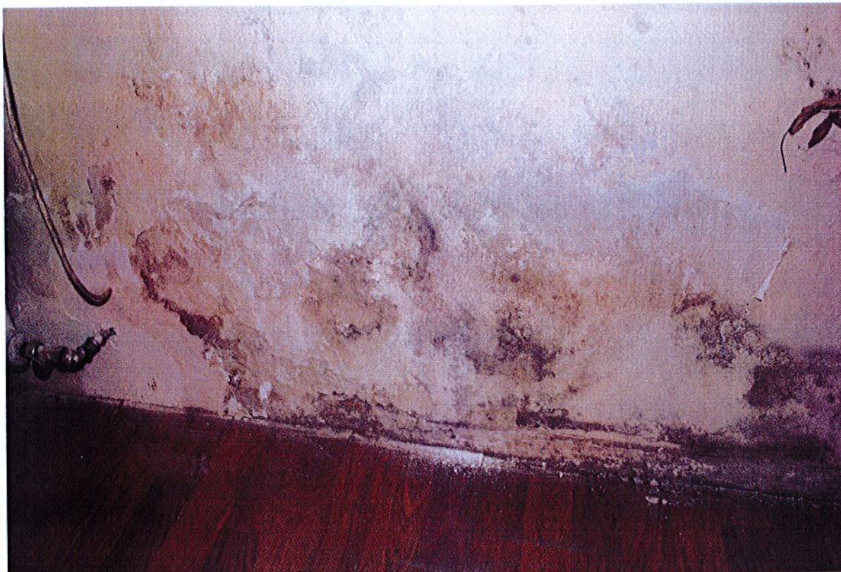
Fot.53. Kołobrzeg, Ratusz, Restauracja Adabar „biuro” restauracji. Ślady zawilgocenia i kolonie grzybów strzępkowych w przyziemiu pomieszczenia, ściana północna.
