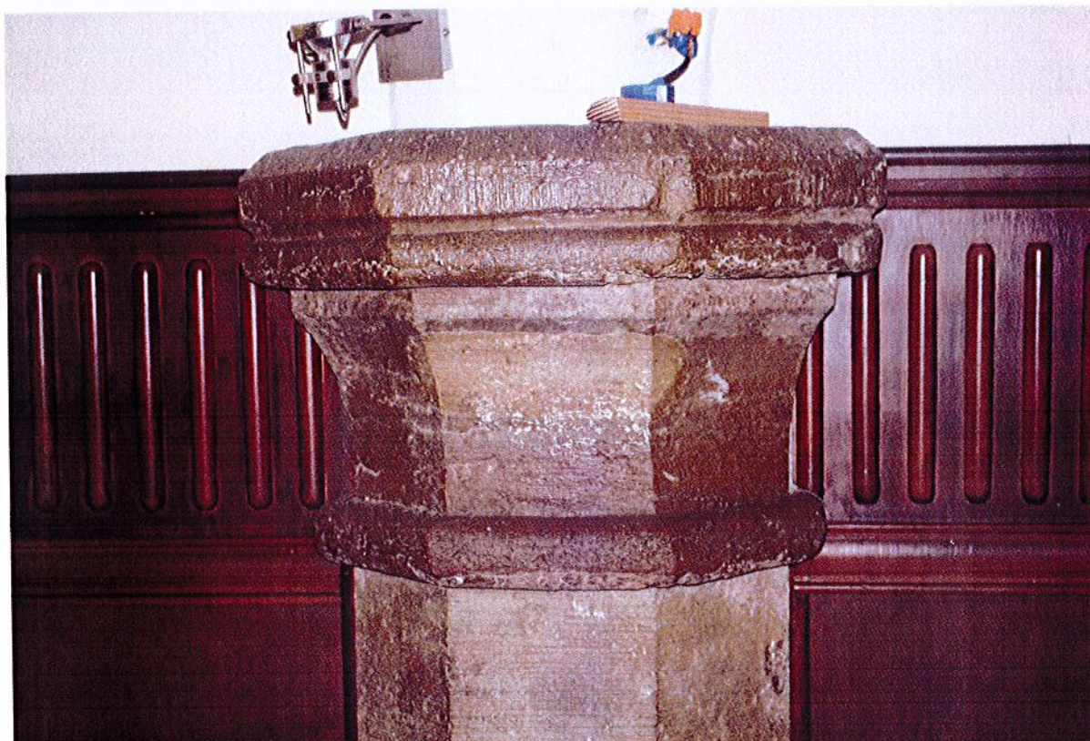
Fot.26. Kołobrzeg, Ratusz, Restauracja Adabar, główna sala restauracji. Półkolumna z wapienia zbitego, z III fazy chronologicznej. Powierzchnia kamienia jest silnie zatuszczona, najprawdopodobniej pokryta „domowymi” preparatami do pielęgnacji kamienia.
