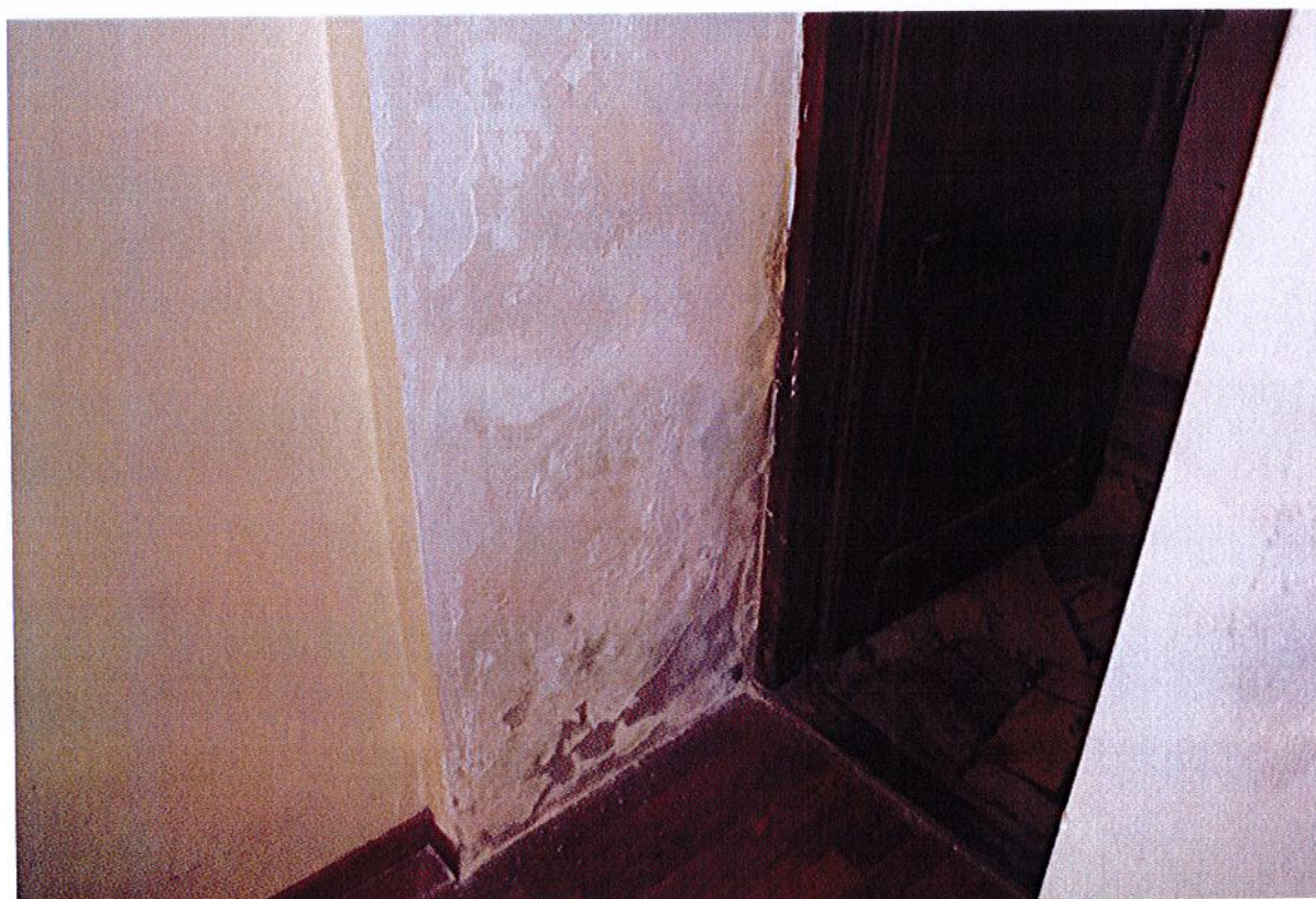
Fot.54. Kołobrzeg, Ratusz, Restauracja Adabar „biuro” restauracji. Nietypowe ślady działania wilgoci w strefie cokołowej ściany działowej. Badanie wilgotności metodą elektrooporową wykazało w tym miejscu 54% wilgotności względnej (materiał suchy do około 20%) i wysokie zasolenie.
