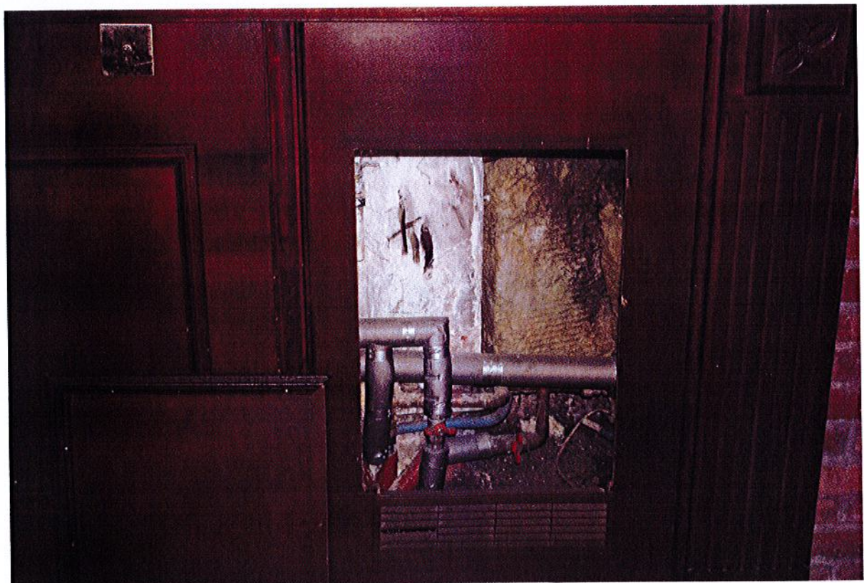
Fot.56. Kołobrzeg, Ratusz, Restauracja Adabar korytarz zaplecza. Silne i nietypowe zawilgocenie ściany działowej.
