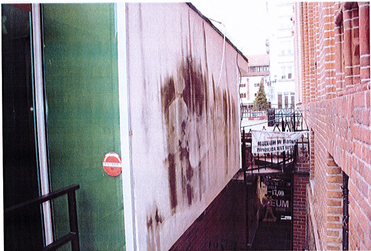
Fot.8. Kołobrzeg, Ratusz, Restauracja Adabar. Podobnie słabo zabezpieczono odpływ wody opadowej z „wiaty”. W tym przypadku pominięto także całkowicie kwestię zebrania wody z krawędzi dachu. Deszczówka zalewa zejście do muzeum.
