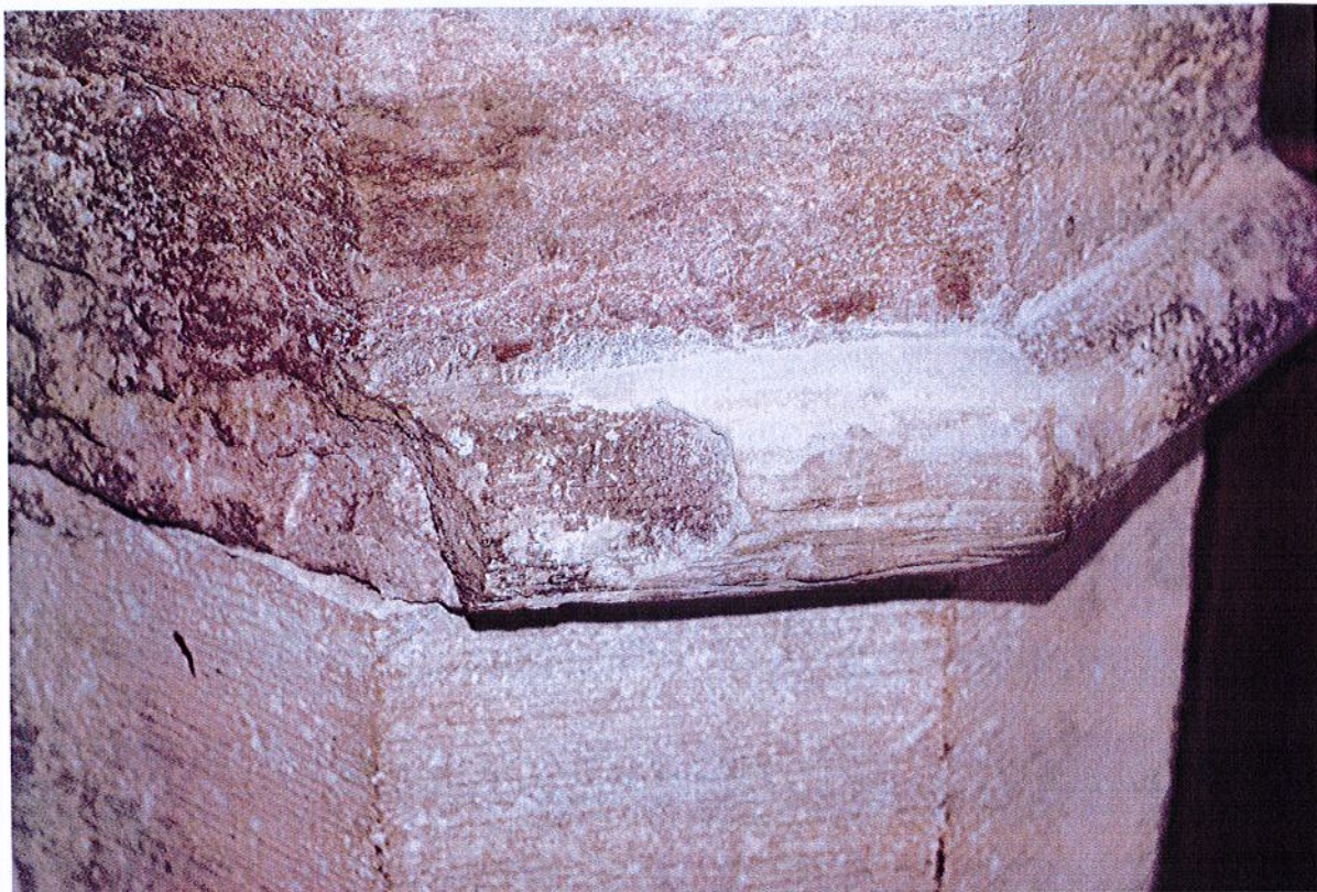
Fot.25. Kołobrzeg, Ratusz, Restauracja Adabar, główna sala restauracji. Półkolumna z wapienia zbitego, z III fazy chronologicznej. Ubytki w obszarach drobnego detalu, wałki, krawędzie powtarzają się na wszystkich kolumnach. Część z uzupełnień nie zachowała się.
