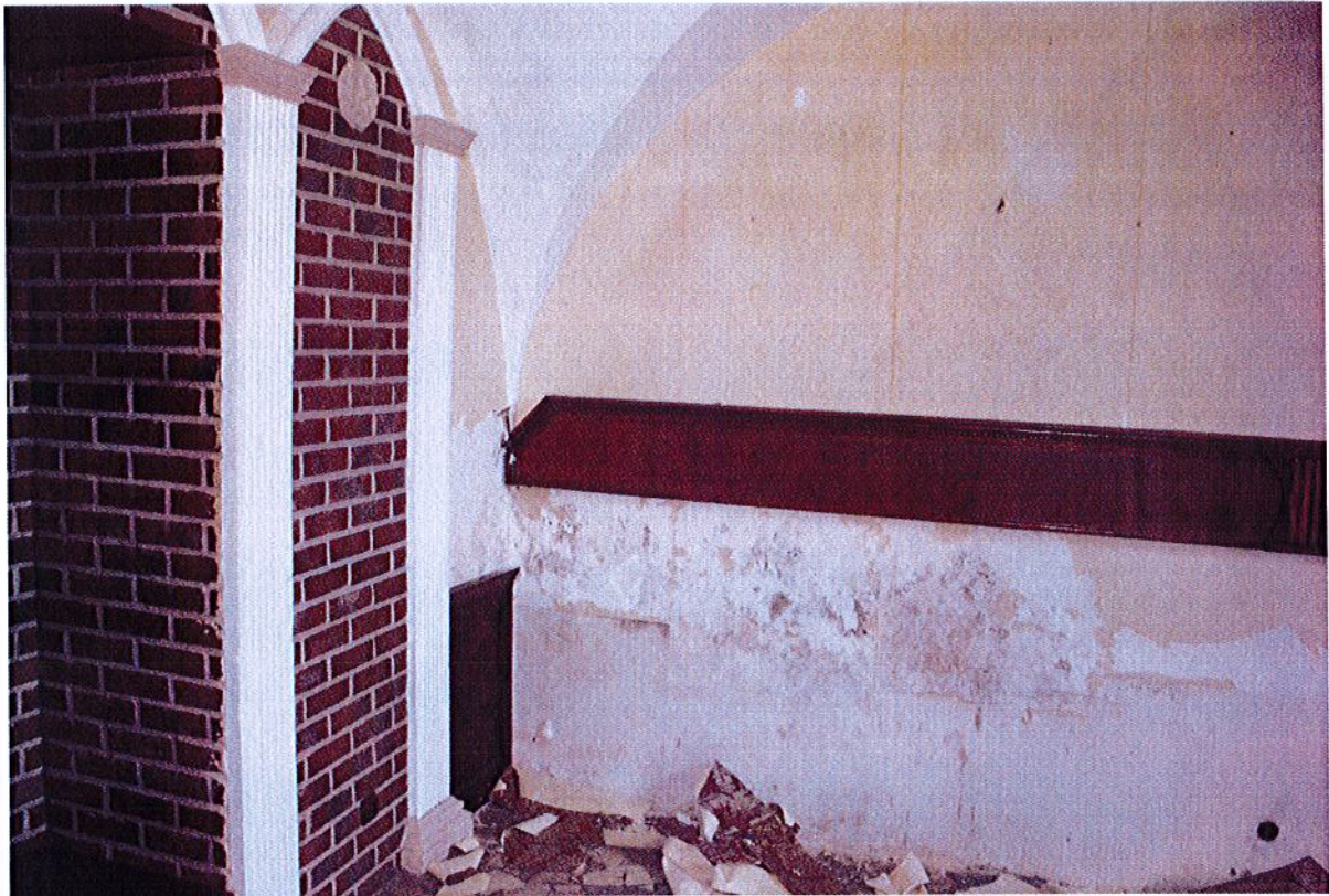
Fot.43. Kołobrzeg, Ratusz, Restauracja Adabar, sala myśliwska. Podobnie jak w pozostałych pomieszczeniach ściany stały się siedliskiem rozległych kolonii grzybów strzępkowych.
