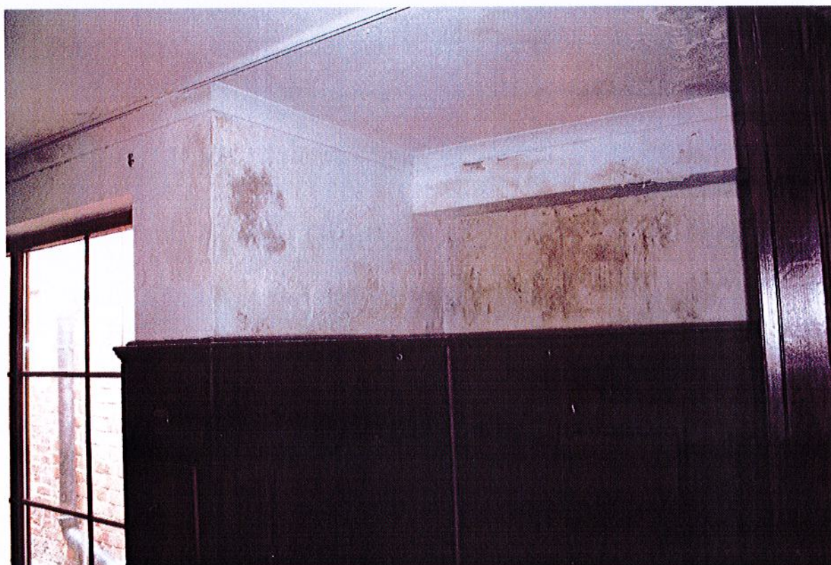
Fot.12. Kołobrzeg, Ratusz, Restauracja Adabar, wewnątrz restauracji-korytarz. Zacieki na ścianach korytarza.
