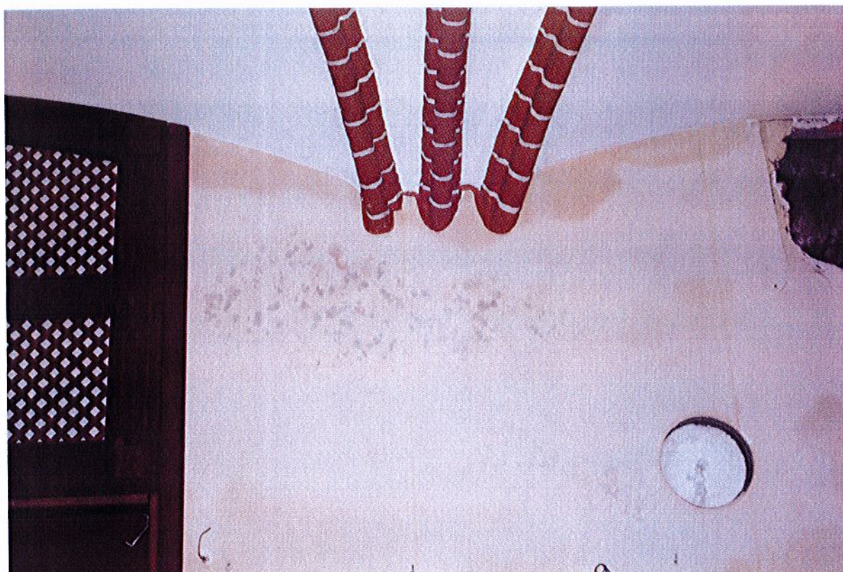
Fot.21. Kołobrzeg, Ratusz, Restauracja Adabar, główna sala restauracji. Pod tapetami czytelne są ślady obecności grzybów strzępkowych, wskazujące na problem z wilgocią kondensacyjną. Podobne ślady obserwuje się we wszystkich pomieszczeniach.
