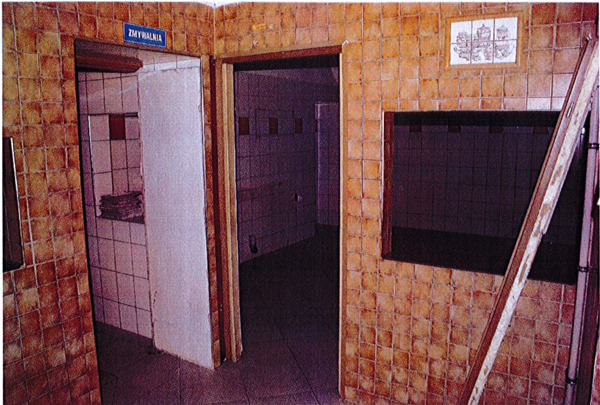
Fot.57. Kołobrzeg, Ratusz, Restauracja Adabar, zaplecze restauracyjne – kuchnia i zmywalnia.
