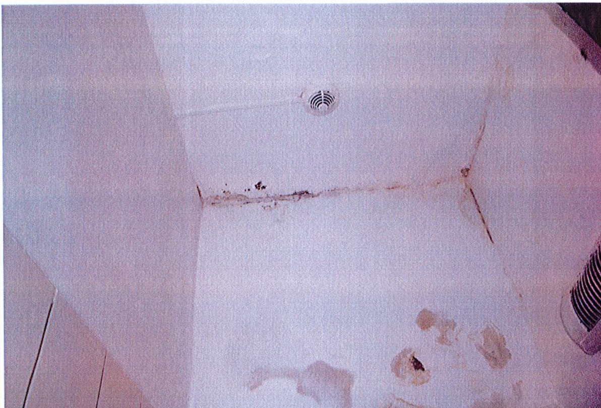
Fot.59. Kołobrzeg, Ratusz, Restauracja Adabar, zaplecze restauracyjne – korytarz. W części tej widoczne są objawy działania wilgoci kondensacyjnej. Dalsze użytkowanie obiektu w charakterze restauracji wymaga przeprojektowania instalacji wentylacyjnej.
