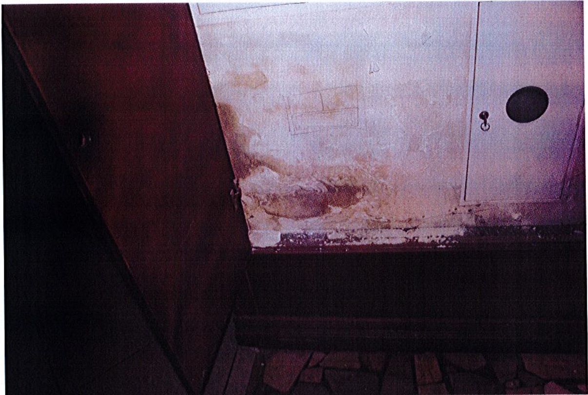
Fot.55. Kołobrzeg, Ratusz, Restauracja Adabar korytarz zaplecza. Silne i nietypowe zawilgocenie ściany działowej.
