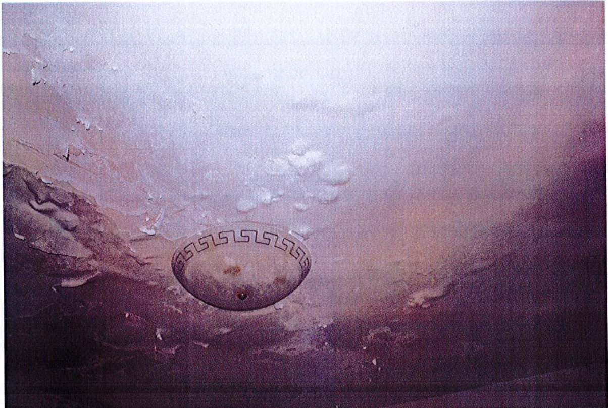
Fot.13. Kołobrzeg, Ratusz, Restauracja Adabar, wewnątrz restauracji-korytarz. Liczne spęcherzenia na suficie wypełnione są zdeintegrowanym tynkiem i depozytami solnymi.
