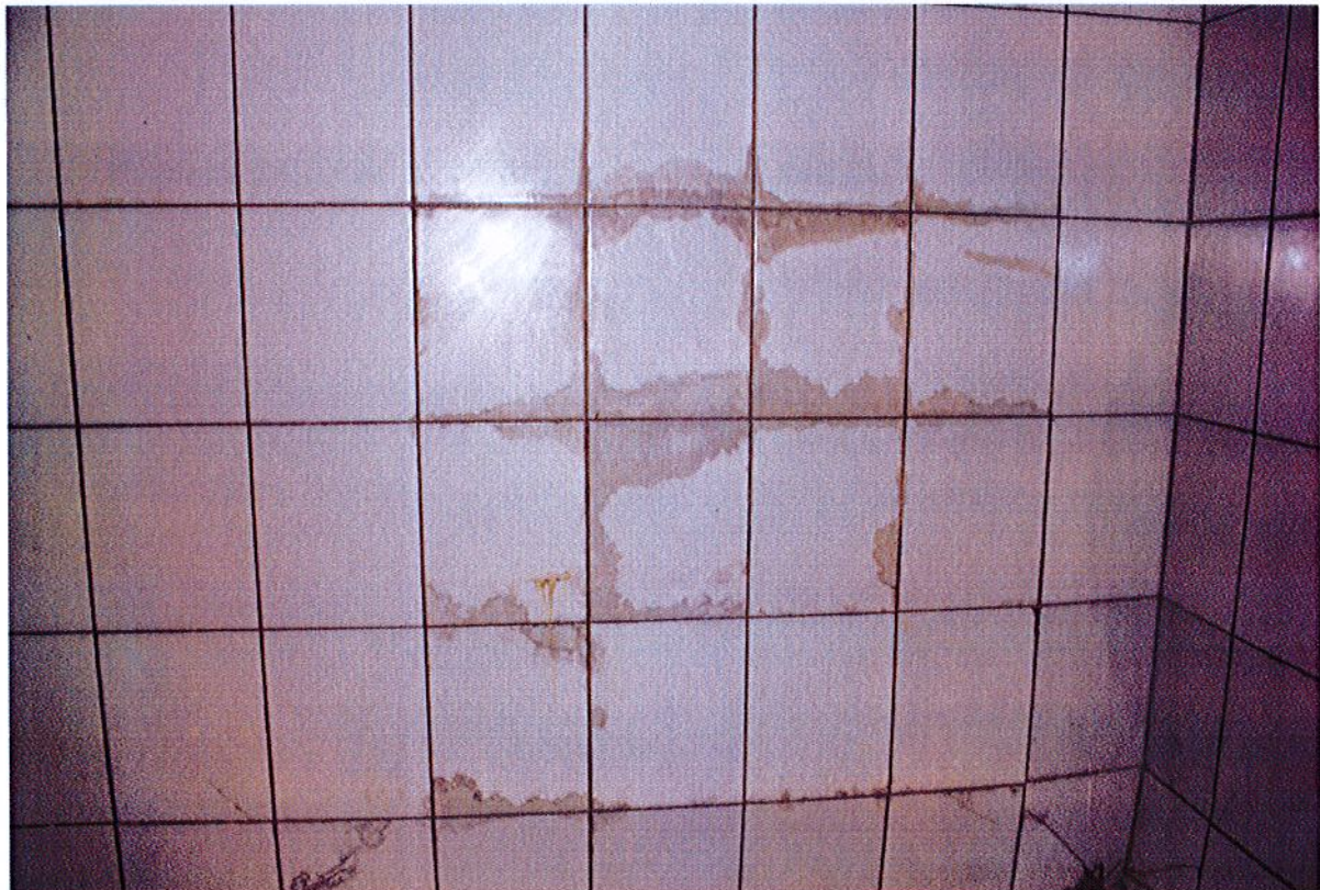
Fot.58. Kołobrzeg, Ratusz, Restauracja Adabar, zaplecze restauracyjne – kuchnia. Na ścianie widoczne objawy korozji biologicznej. Mur pod kafelkami porażony został najprawdopodobniej przez którąś z odmian grzyba domowego.
