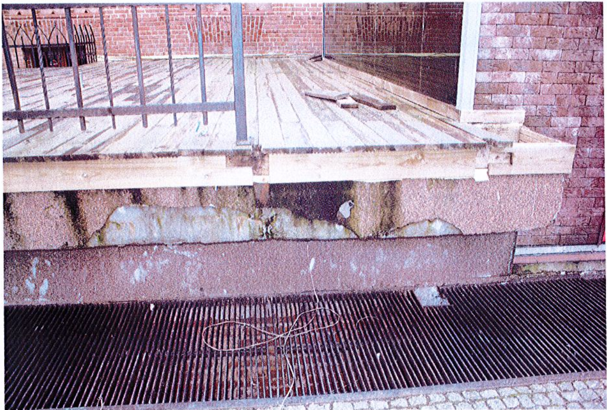
Fot.7. Kołobrzeg, Ratusz, Restauracja Adabar. Krawędzi płyty tarasu pozostawiono niezabezpieczone, pozabawione nawet najprostszych obróbek blacharskich.
