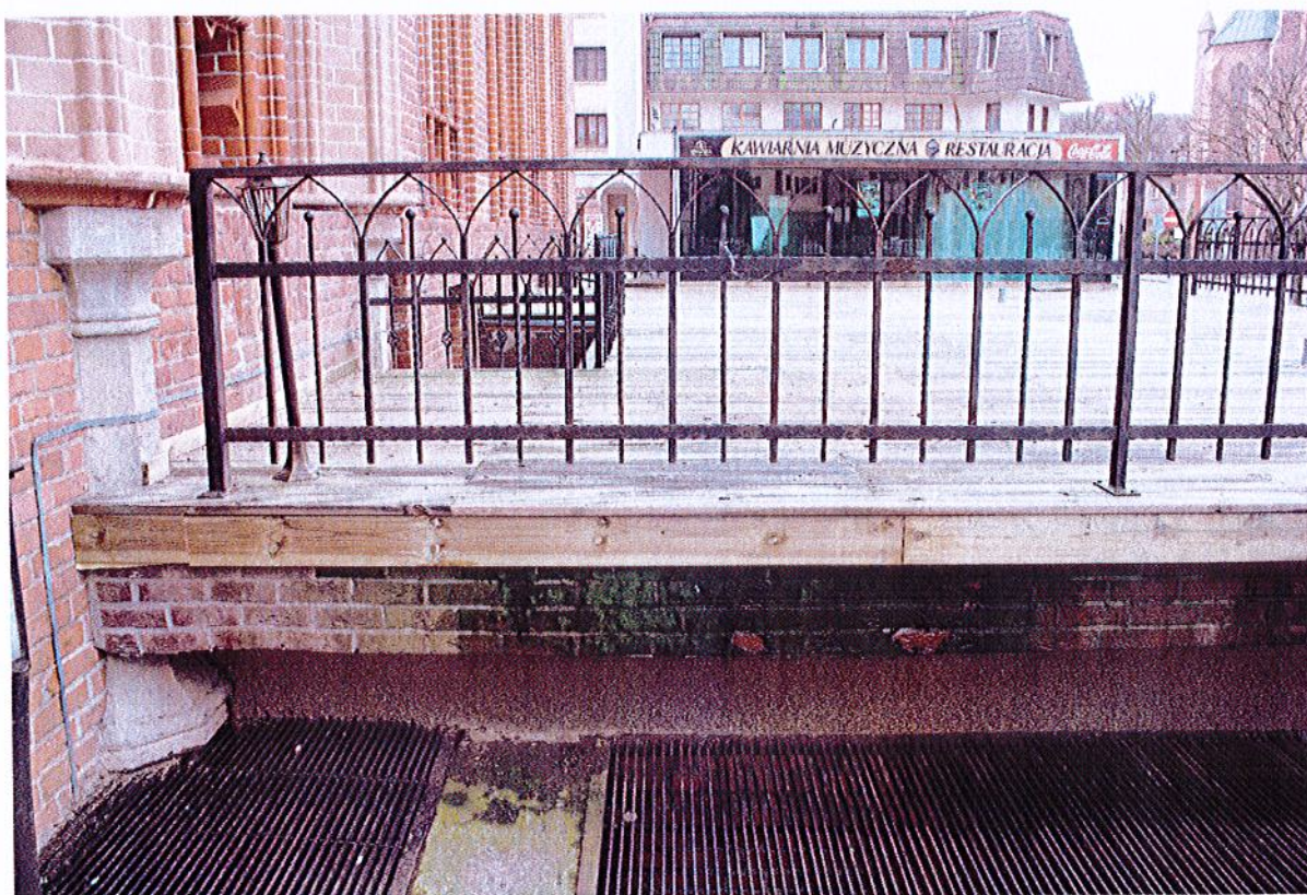
Fot.6. Kołobrzeg, Ratusz, Restauracja Adabar. Płyta tarasu wykazuje silne tendencje do utrzymywania zawilgocenia. Tak silny rozwój glonów możliwy jest jedynie w warunkach stałego zawilgocenia.
