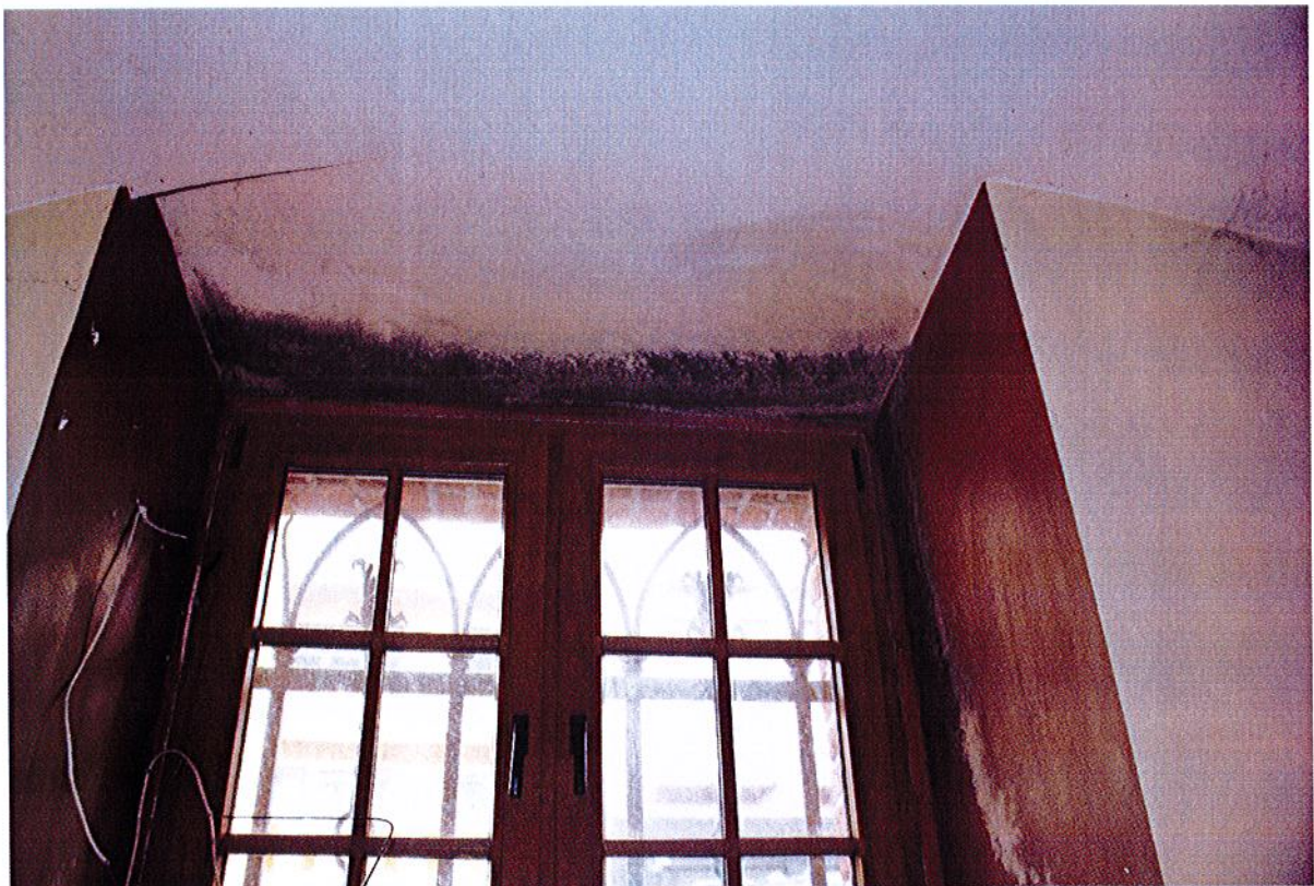
Fot.52. Kołobrzeg, Ratusz, Restauracja Adabar „biuro” restauracji. Ślady zawilgocenia i kolonie grzybów strzępkowych w miejscu typowego powstawania mostków termicznych.
