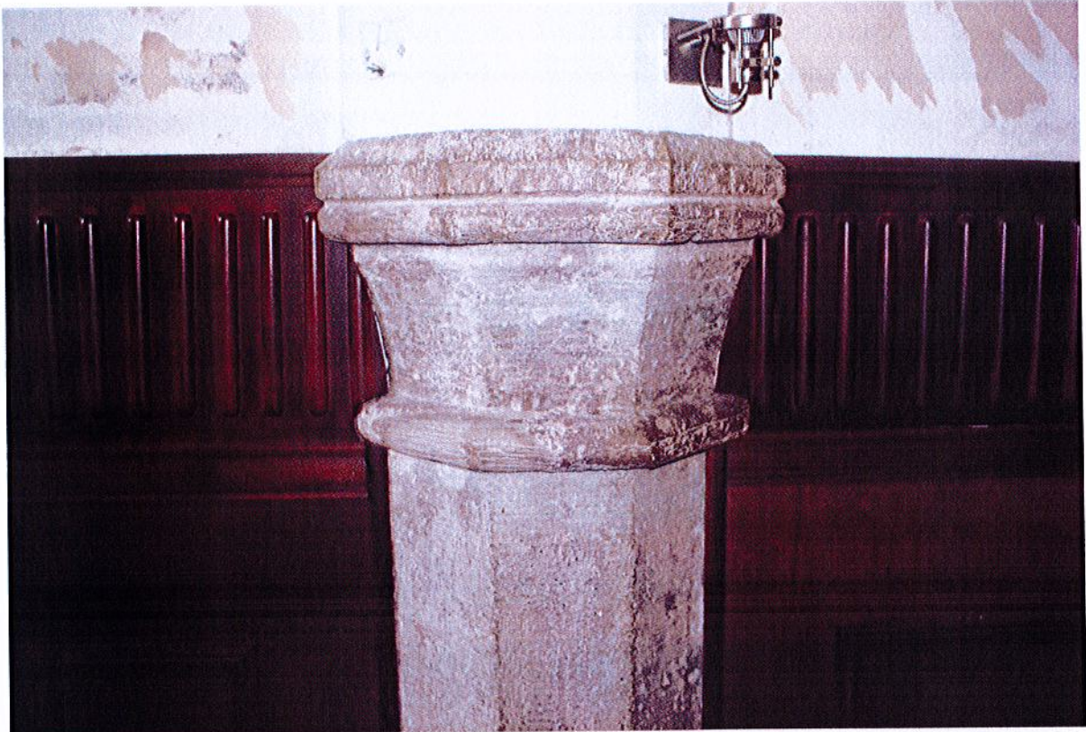
Fot.23. Kołobrzeg, Ratusz, Restauracja Adabar, główna sala restauracji. Półkolumna z wapienia zbitego, z III fazy chronologicznej. Na wałku oddzielającym kapitel i trzon wyróżnia się uzupełnienie z szarej zaprawy mineralnej.
