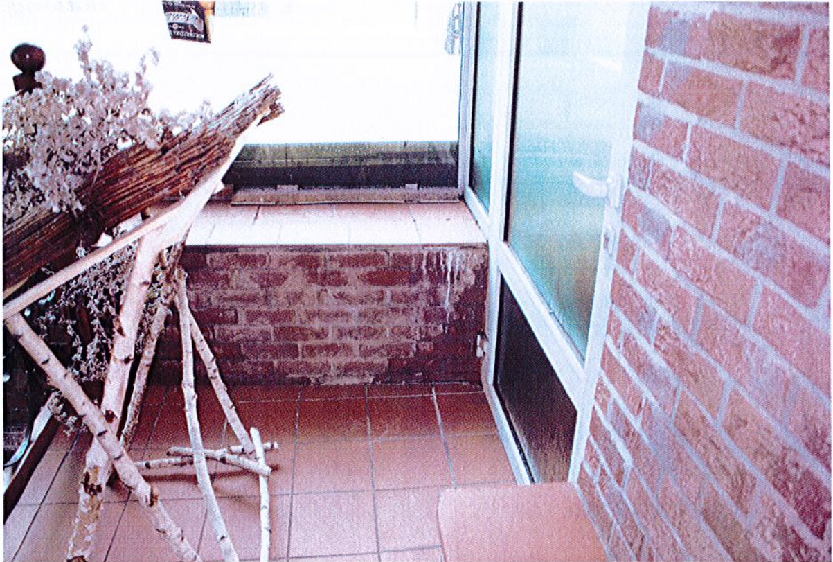
Fot.9. Kołobrzeg, Ratusz, Restauracja Adabar, wnętrze klatki schodowej. Słabe uszczelnienia pomiędzy cokółem a stolarką windy powoduje zalewanie jej wnętrza. Na parapecie cokołu widoczne są węglanowe wysolenia i ciemne plamy wilgoci.
