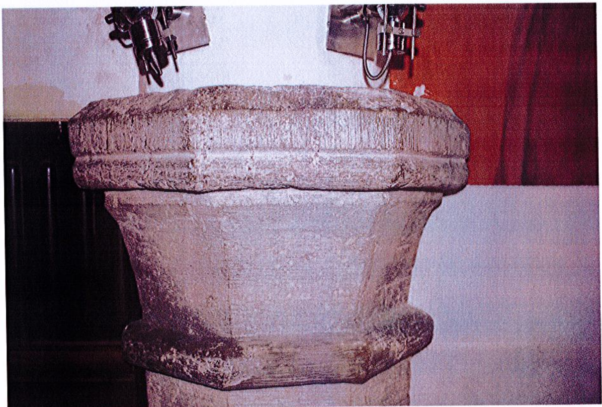
Fot.24. Kołobrzeg, Ratusz, Restauracja Adabar, główna sala restauracji. Półkolumna z wapienia zbitego, z III fazy chronologicznej. Na wałku oddzielającym kapitel i trzon wyróżnia się uzupełnienie z szarej zaprawy mineralnej.
