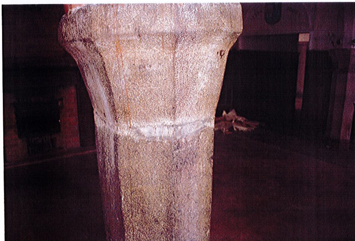
Fot.22. Kołobrzeg, Ratusz, Restauracja Adabar, główna sala restauracji. Kolumna granitowa z I fazy chronologicznej. Pęknięcie, lub zamierzony podział pomiędzy bryłami kolumny wypełniono zaprawą mineralną. Na zdjęciu widoczna także deformacja geometrii spowodowana przesunięciem elementów. Granit jest wyraźnie zabrudzony i zatłuszczony.
