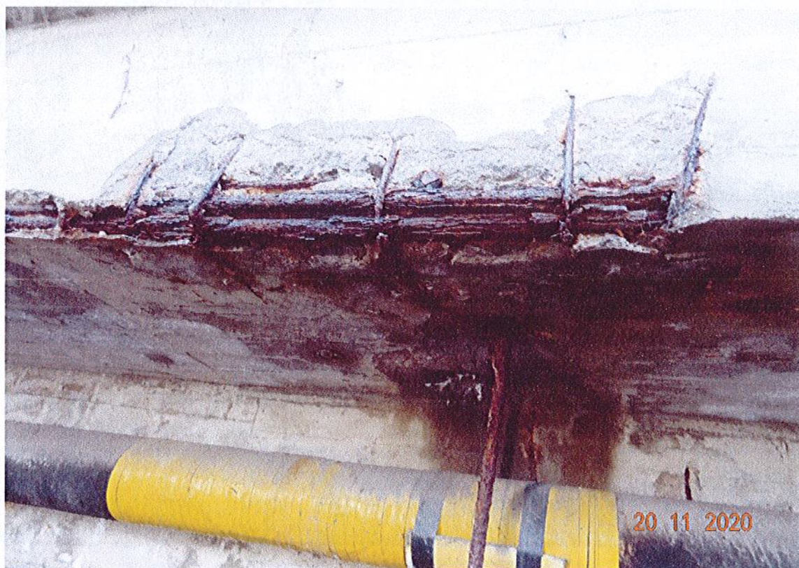
Fot. 11. Widok wspornika podchodnikowego od strony Kanału Drzewnego. Ubytki w konstrukcji, odkryte skorodowane zbrojenie.
