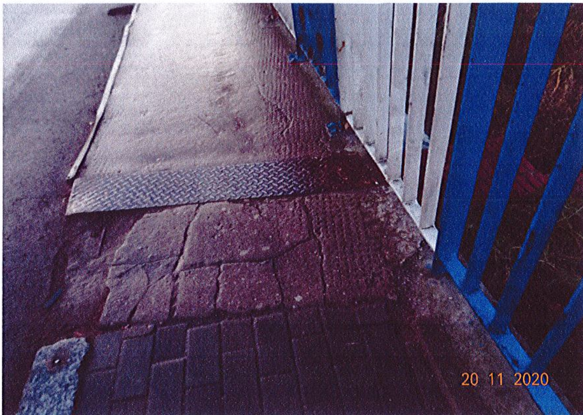
Fot. 25. Widok nawierzchni chodnika od strony Parsęty. Widoczne nierówności i ubytki nawierzchni przy płycie dylatacyjnej. Widoczne ślady ognisk korozji na balustradzie.
