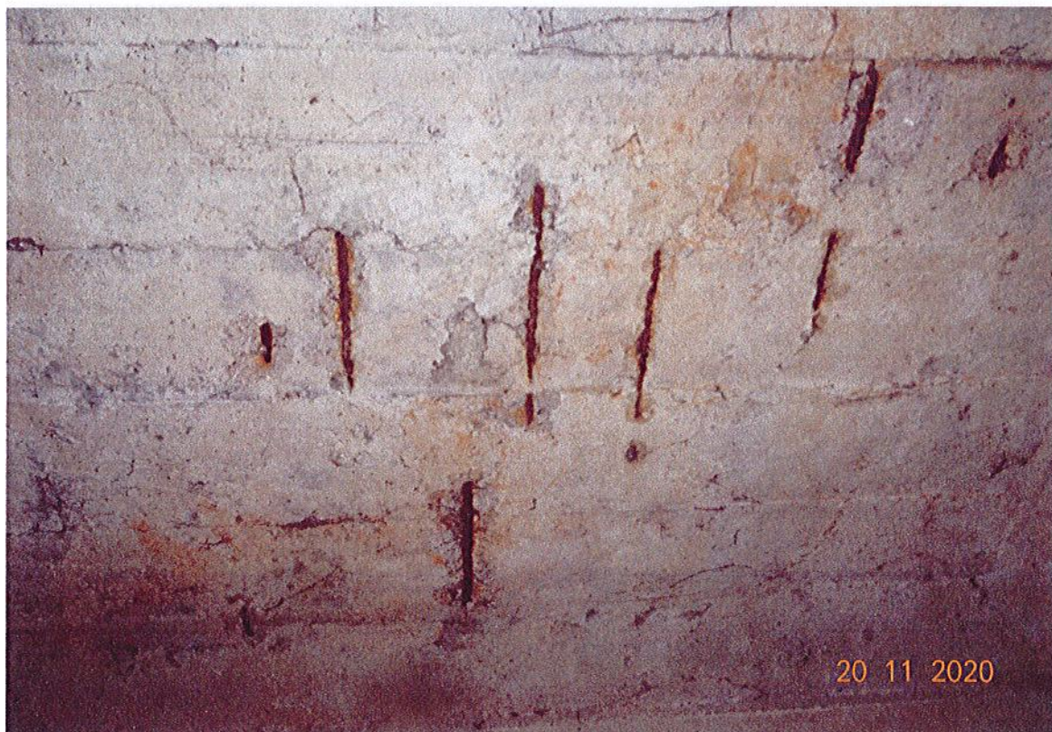
Fot. 17. Widok płyty pomostu. Widoczne pręty zbrojenia płyty wyraźnie skorodowane oraz ubytki i spękania w betonowej powierzchni płyty.
