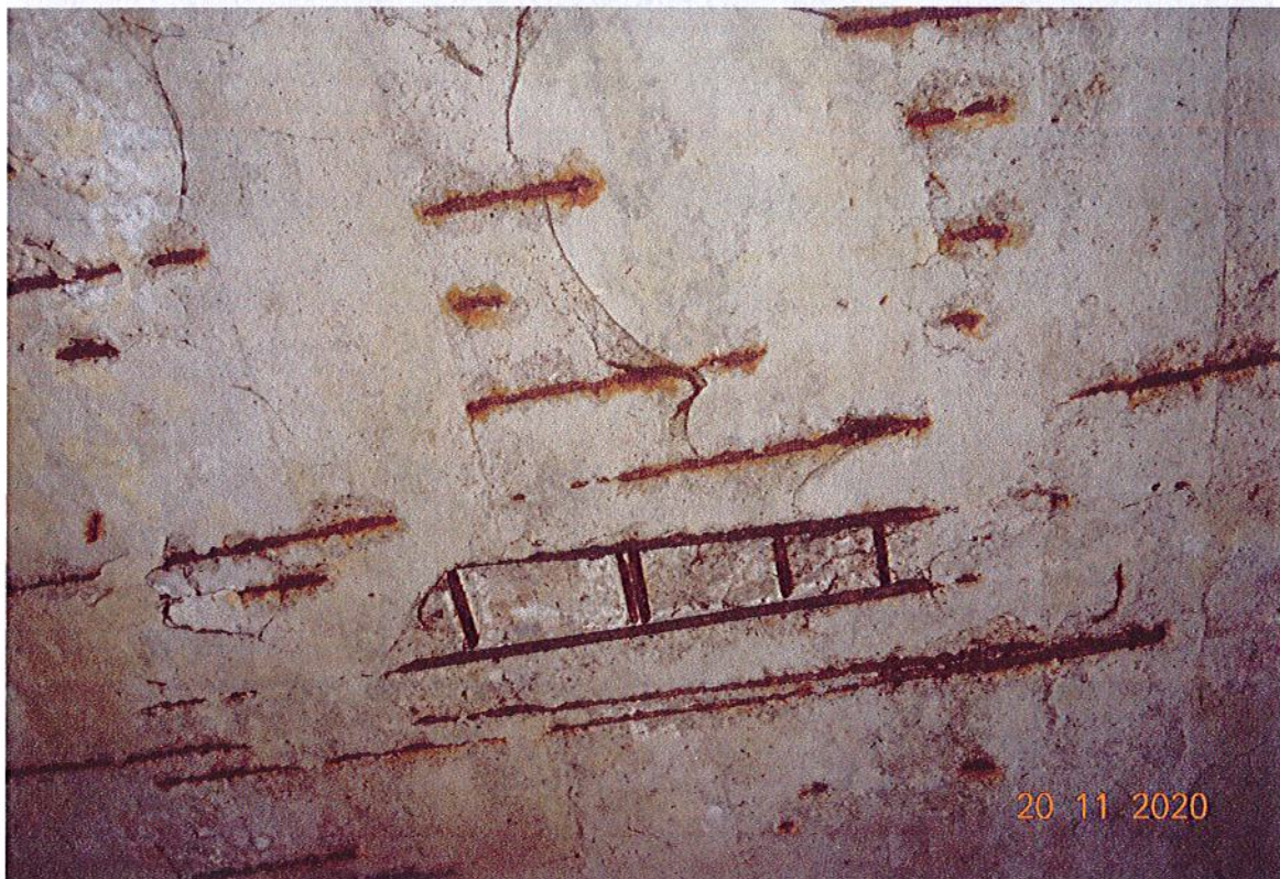
Fot. 21. Widok płyty pomostu. Widoczne pręty zbrojenia płyty wyraźnie skorodowane oraz ubytki i spękania w betonowej powierzchni płyty.
