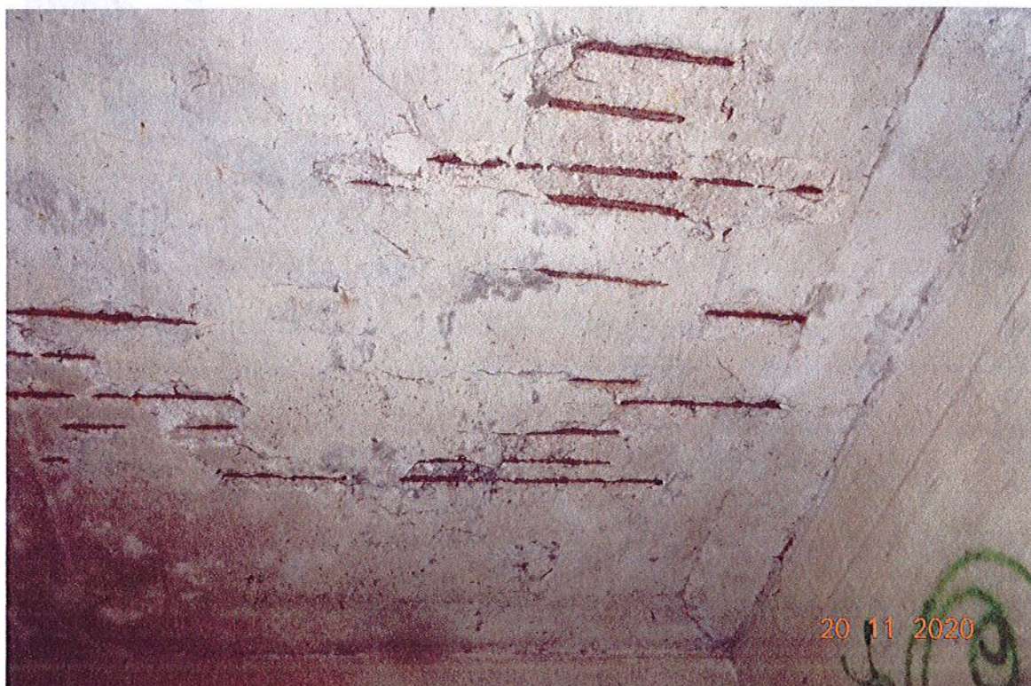
Fot. 18. Widok płyty pomostu. Widoczne pręty zbrojenia płyty wyraźnie skorodowane oraz ubytki i spękania w betonowej powierzchni płyty.
