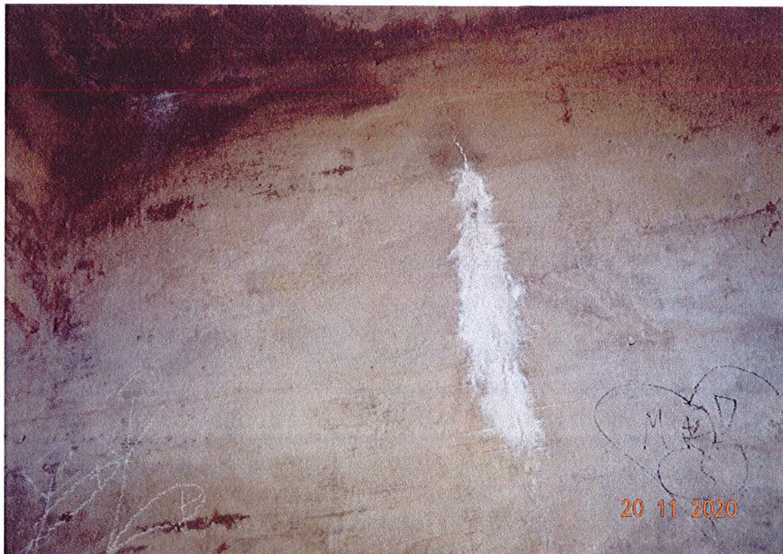
Fot. 23. Widok pierwszego dźwigara od strony Kanału Drzewnego. Widoczne pęknięcie powierzchni z wykwitami i naciekami.
