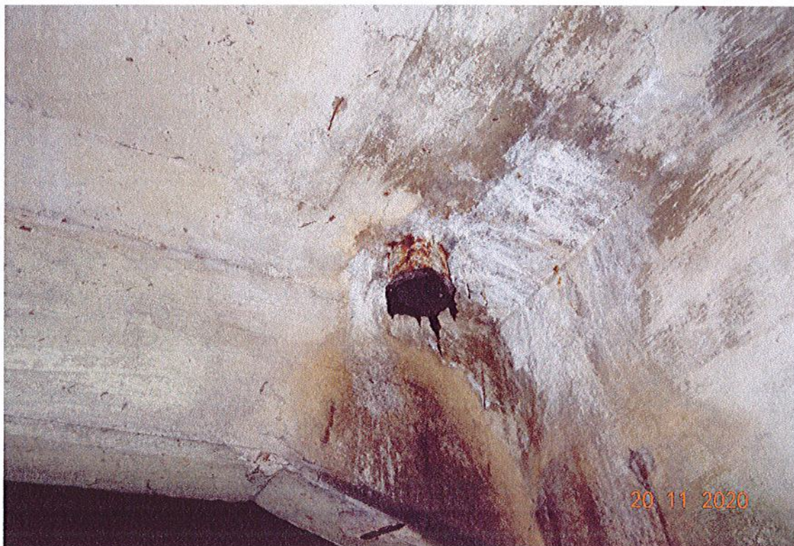
Fot. 24. Widok płyty pomostu z rurą odpływową wpustu ulicznego na obiekcie. Widoczne wykwit i zaciek na powierzchni płyty i dźwigara..
