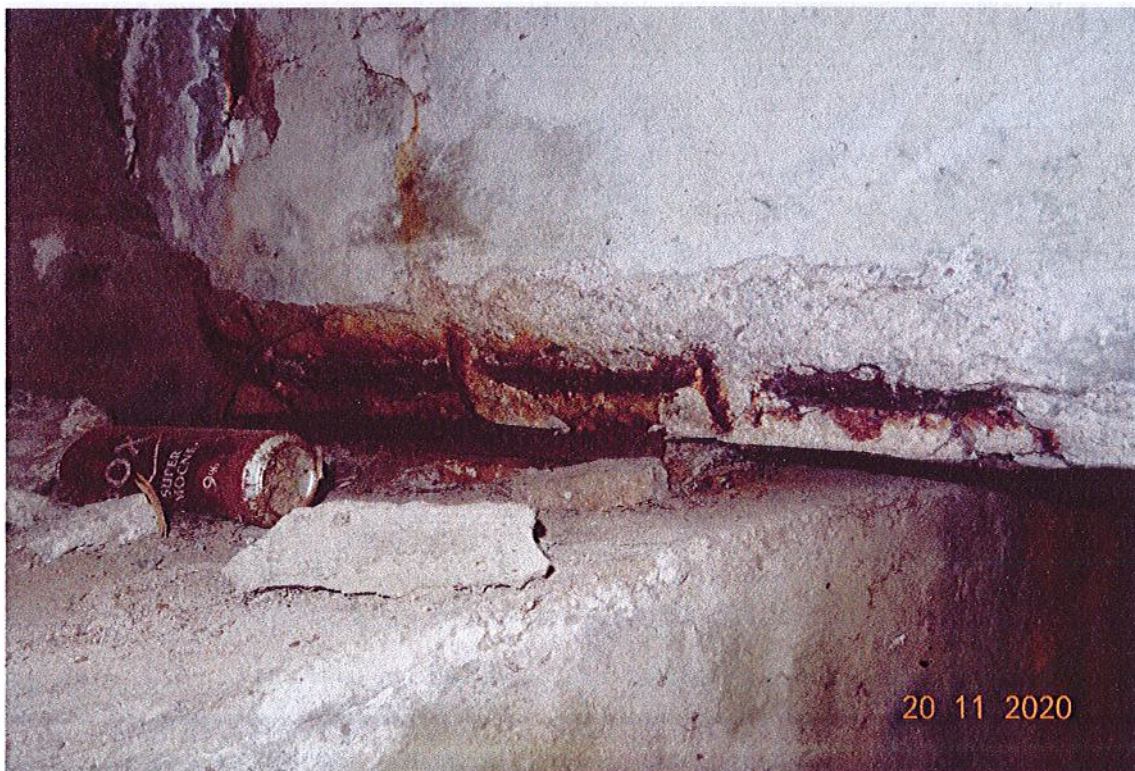
Fot. 22. Widok dźwigara wspartego na podporze. Łożysko mocno skorodowane, Widoczne ubytki i odpęnięcia powierzchni dźwigara, wyraźnie skorodowane zbrojenie.
