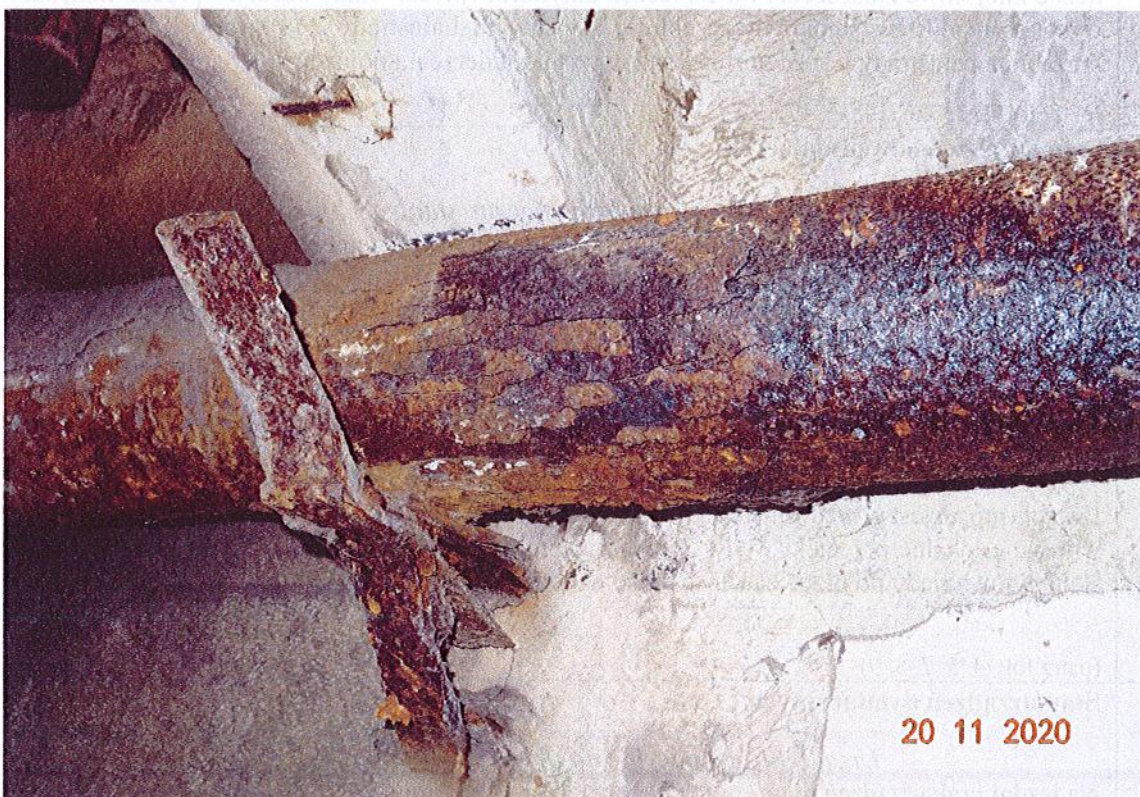
Fot. 28. Widok urządzenia obcego na obiekcie. Widoczna korozja rury osłonowej oraz jej mocowania do obiektu.
