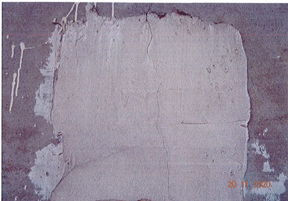
Fot. 15. Widok pierwszego dźwigara od strony Parsęty. Widoczny znacznik na powierzchni konstrukcji z wyraźnym pęknięciem prostopadłym do osi obiektu.
