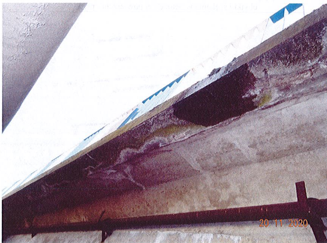
Fot. 16. Widok płyty wspornika pochodnikowego od strony Parsęty. Widoczne zacieki i przebarwienia oraz pęknięcia i ubytki w powierzchni płyty.
