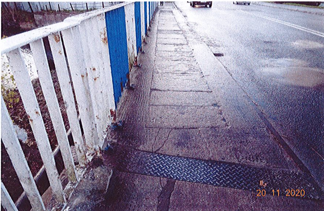
Fot. 26. Widok nawierzchni chodnika i jezdni od strony Kanalu Drzewnego. Widoczne nierówności i ubytki płyt kanału technicznego w nawierzchni chodnika oraz nierówności nawierzchni jezdni. Wyraźne ślady ognisk korozji na balustradzie.
