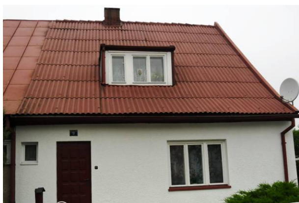
Rys. 10. Pokrycie dachowe ocenione w III stopniu pilności.
