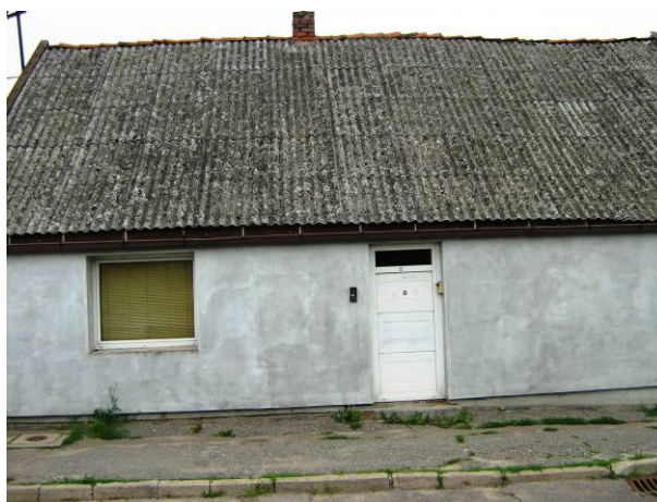
Rys. 11. Pokrycie dachowe ocenione w II stopniu pilności.
