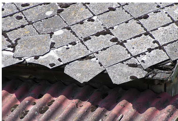
Rys. 8. Pokrycie dachowe ocenione w I stopniu pilności.
