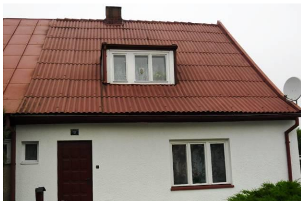
Rys. 6. Pokrycie dachowe ocenione w III stopniu pilności.
