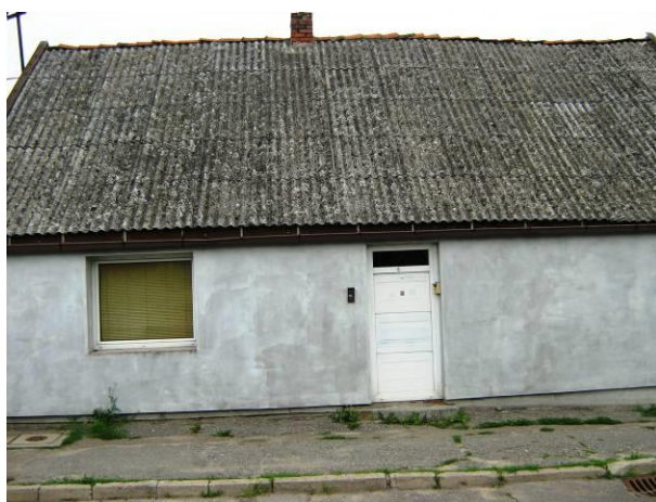
Rys. 7. Pokrycie dachowe ocenione w II stopniu pilności.
